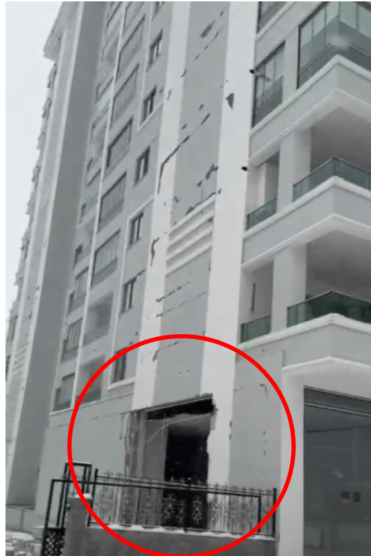
Şekil 24. Yüzakı Bulvarı'ndaki yapıların dolgu duvarlarının yıkılması (Yeşilyurt, Malatya)
