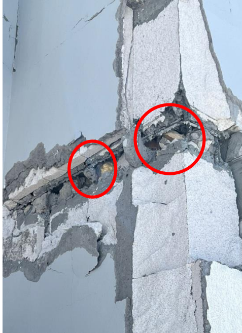
Şekil 21. Beton içerisinde bulunan yabancı maddeler (Malatya)
