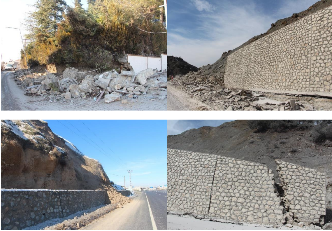
Şekil 48. Dayanma yapısı hasarları (Malatya, Malatya-Adıyaman otoyolu)
