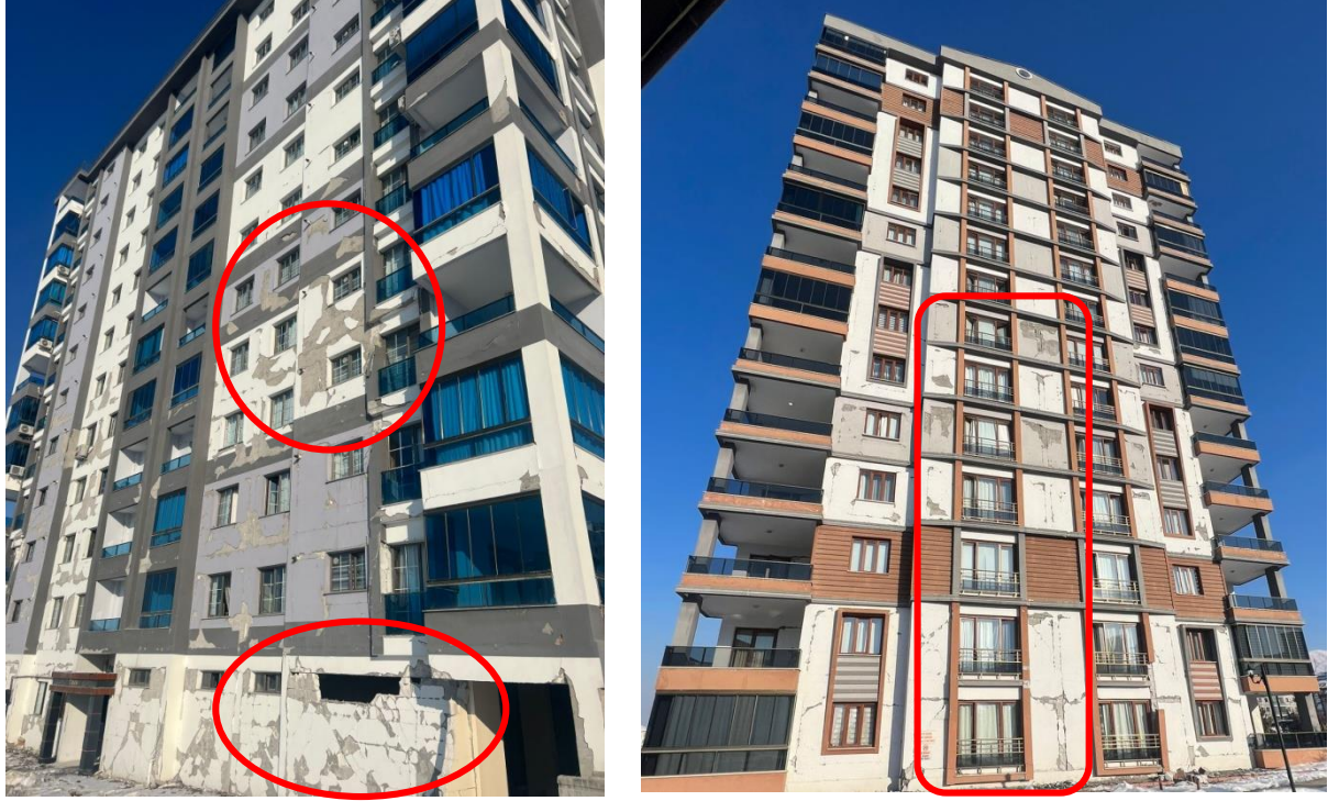
Şekil 19. Yapı dış yüzeyinde gözlenen duvar çatlakları ve sıva dökülmeleri (Malatya)
