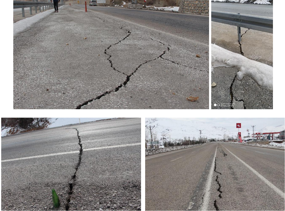
Şekil 45. Asfalt kaplama hasarları (Adıyaman, Malatya)
