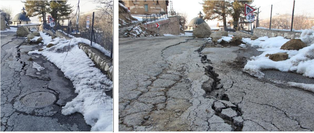
Şekil 43. Dayanma yapısı geri dolgusu akmaları ve asfalt kaplama deformasyonları (Malatya)
