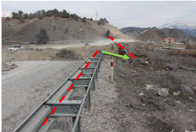
Şekil 47. Fay atımına bağlı yol ötelenmesi (Adıyaman)
