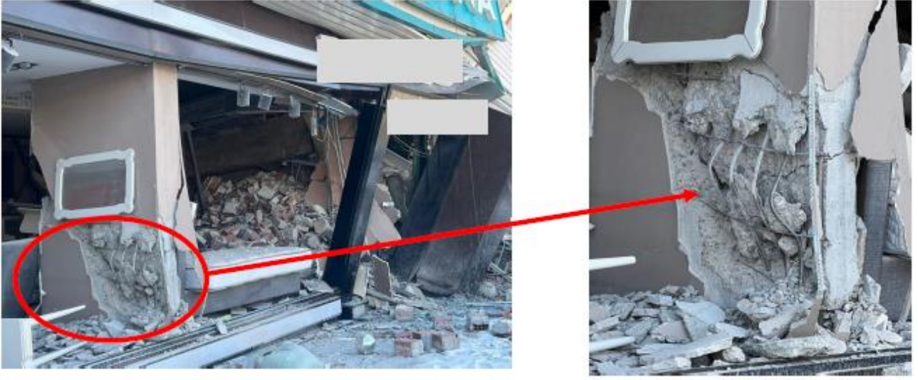
Şekil 17. İnönü caddesinde bulunan eski yapı stokunda rastlanan kusurlar (Malatya)
