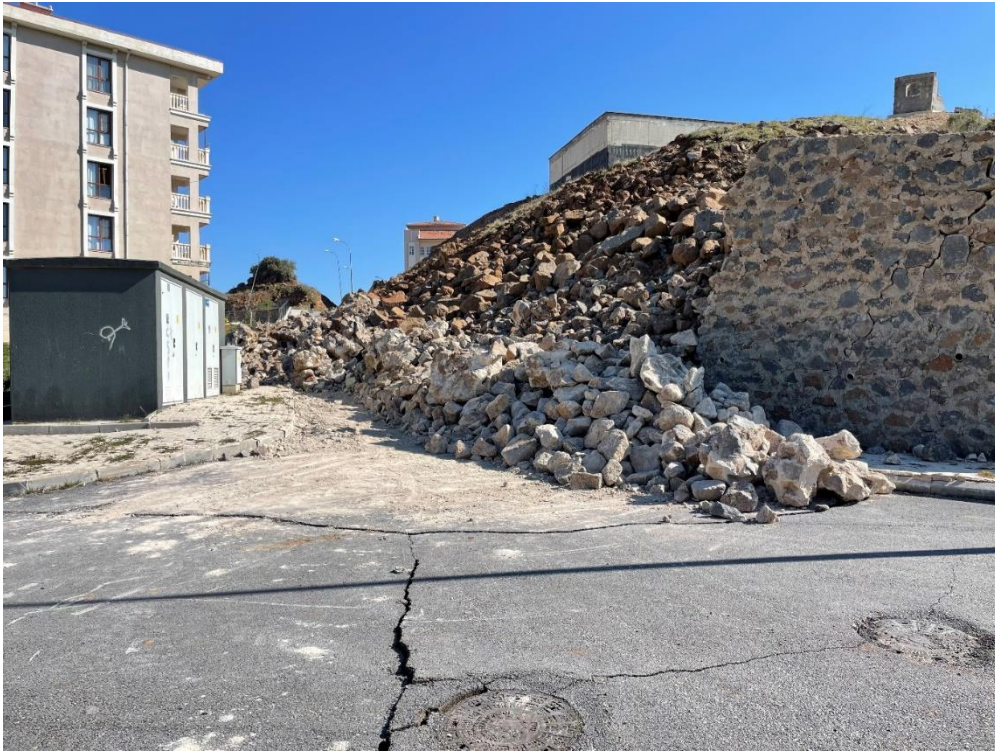
Şekil 4.17 Gaziantep İslâhiye ilçesi Fevzipaşa 3. Etap TOKİ konutları taş duvar hasarları
