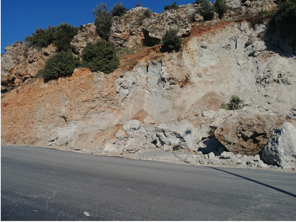
Şekil 4.7 Fevzipaşa mahallesi ve İstasyon yolu arasında gözlenen kaya kopmaları ve düşmeleri.
