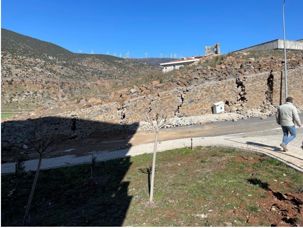
Şekil 4.16 Gaziantep İslâhiye ilçesi Fevzipaşa 3. Etap TOKİ konutları dolgu şevde yanal deformasyonlar sonucu istinat duvarlarındaki ayrılmalar
