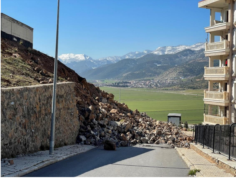
Şekil 4.18 Gaziantep İslâhiye ilçesi Fevzipaşa 3. Etap TOKİ konutları taş duvar hasarları
