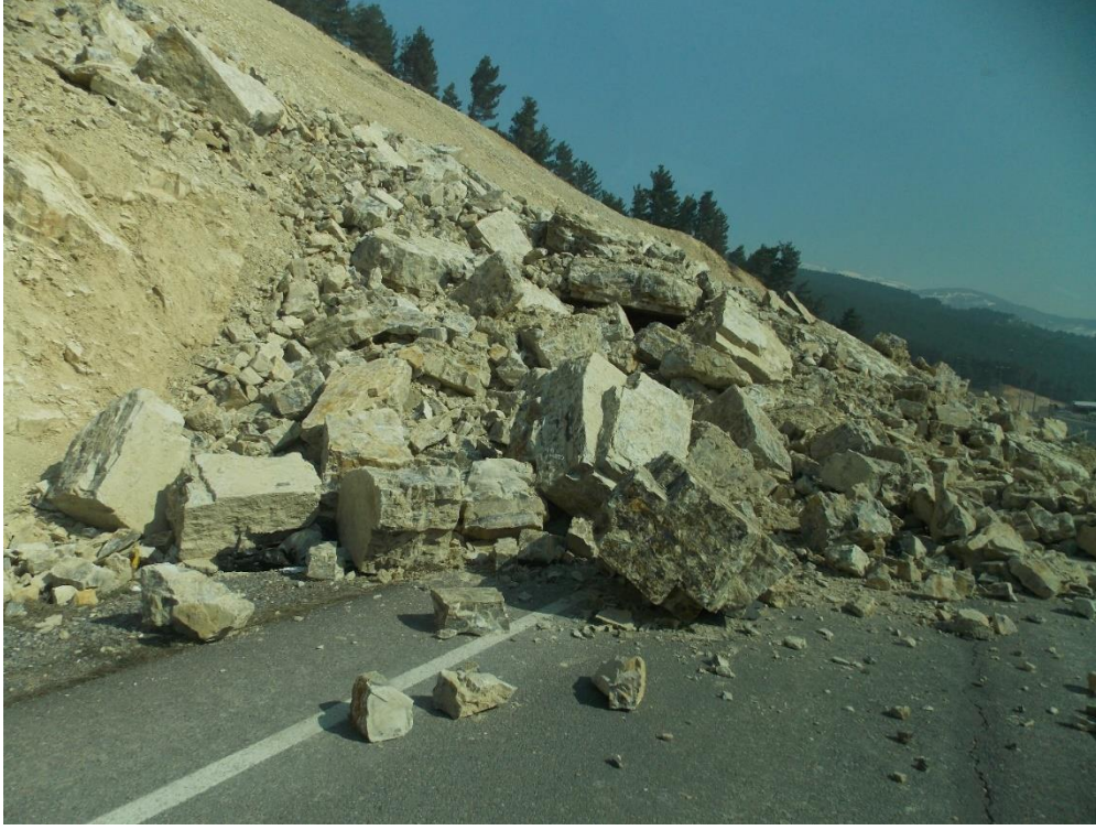
Şekil 4.27 Kahramanmaraş kuzey çevreyolu kaya kütle yenilmesi yakından görünümü
