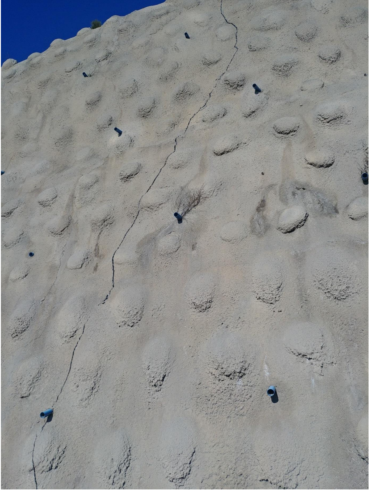
Şekil 4.21 Gaziantep İslâhiye ilçesi Fevzipaşa mahallesi girişi bölünmüş stabilize edilmiş yol yarmalarında çatlaklar
