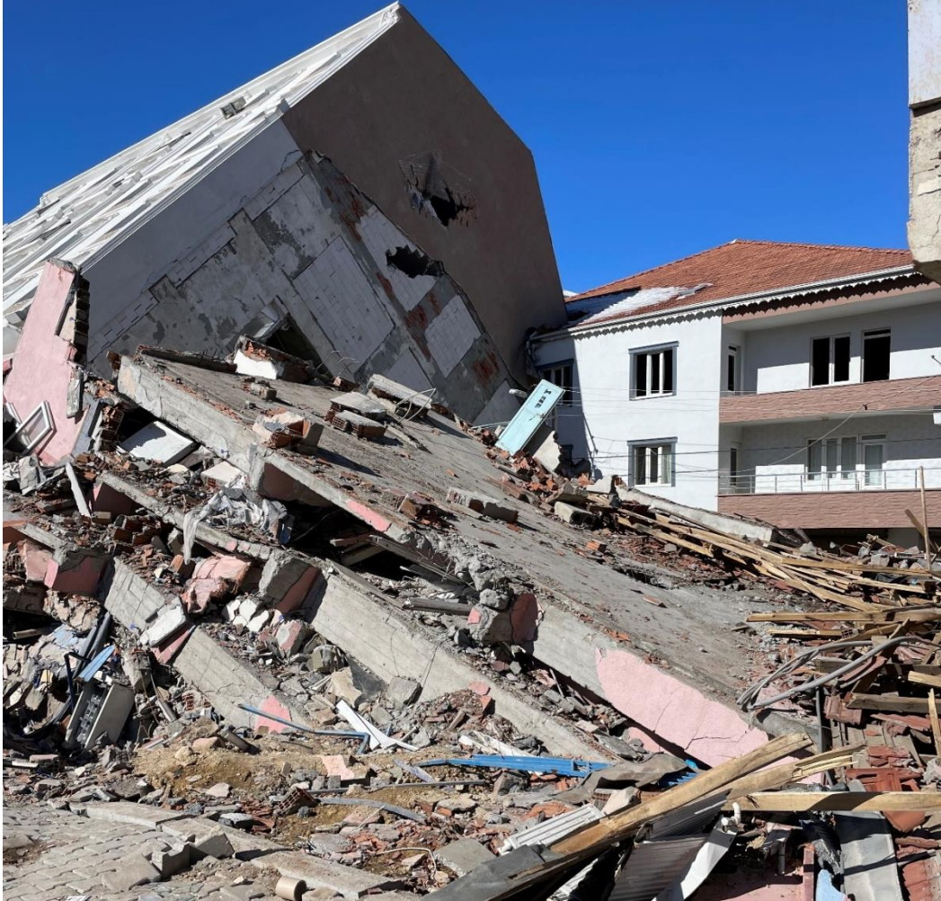
Şekil 4.3 Devrilen ve yıkılan binalar, Gölbaşı-Adıyaman
