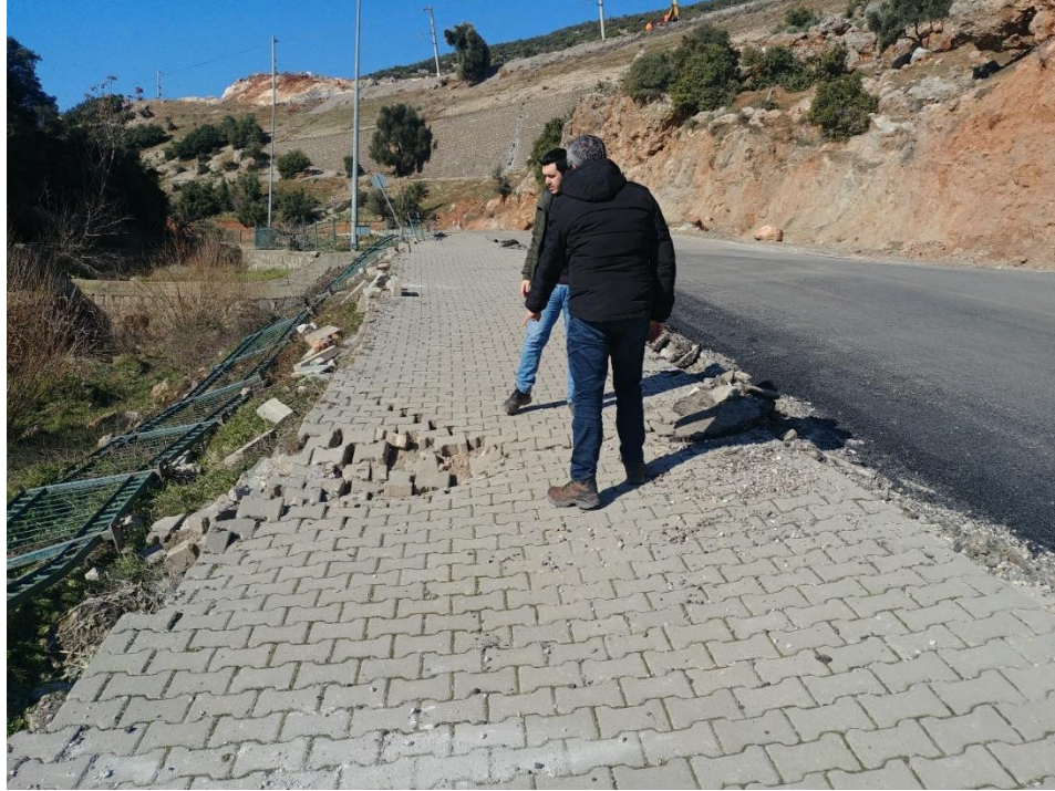
Şekil 4.9 Yolun karşısına geçen kayaların yuvarlanmak yerine zeminde çarparak ve sıçrayarak hareket ettiği, kaldırımda bıraktığı izlerde ve yıktığı demir çitten anlaşılmaktadır.
