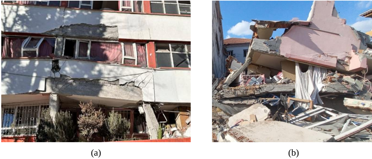
Şekil 5.9 Zayıf kolon, güçlü kiriş problemi a) Kahramanmaraş, b) Gölbaşı
