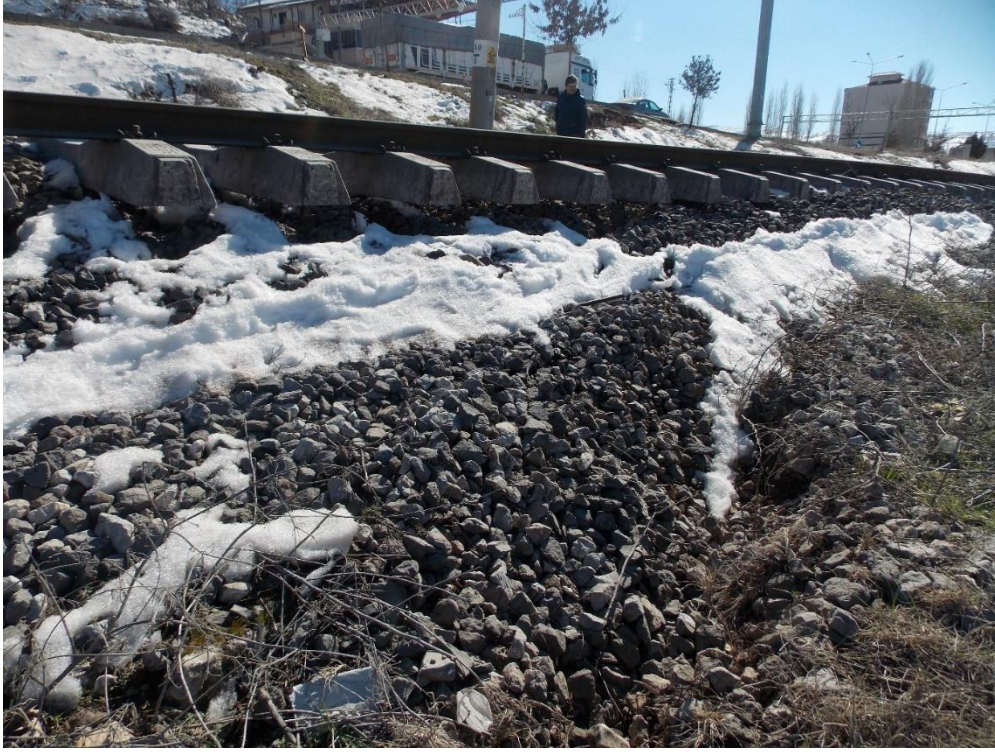
Şekil 4.36 Adıyaman Gölbaşı ilçesi yumuşak kil tabakadaki yanıl deformasyonlar sonucu demiryolu altında boşalmalar
