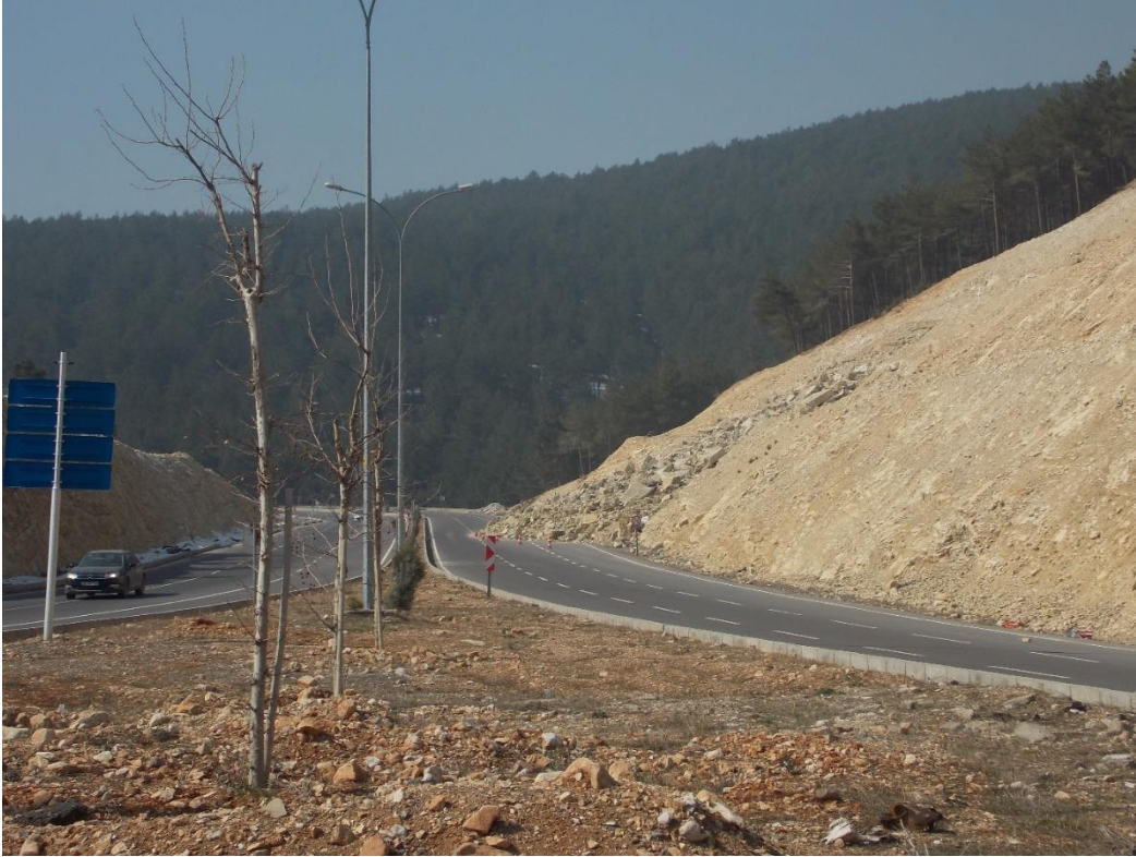
Şekil 4.6 Kahramanmaraş İl Merkezi kuzeyinde çevre yolunda gözlenen kaya kopmaları ve düşmeleri.
