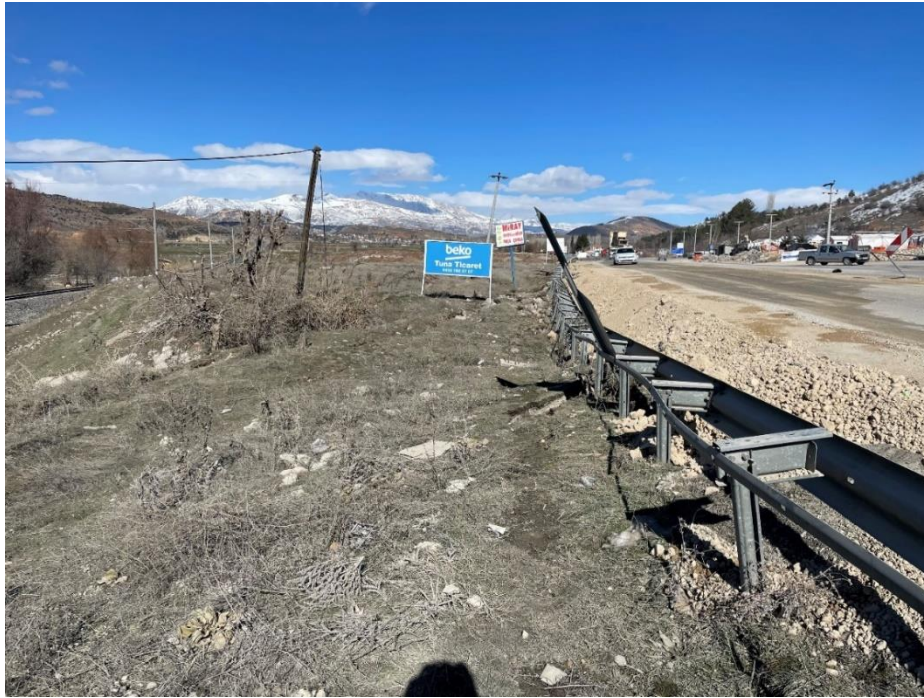
Şekil 4.13 Adıyaman Gölbaşı ilçesi yumuşak kil tabakaya oturan yol dolgusu heyelanı
