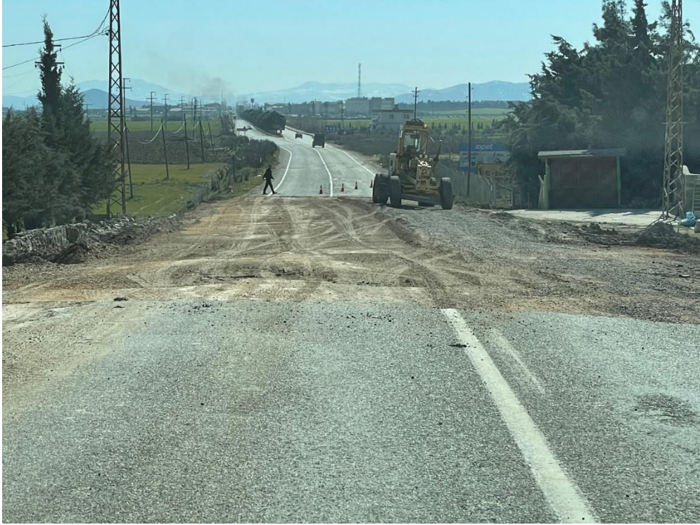
Şekil 4.29 Gaziantep İslâhiye ilçesi Türkbahçe mahallesi fay atımı dolayısı ile yolda deformasyonlar
