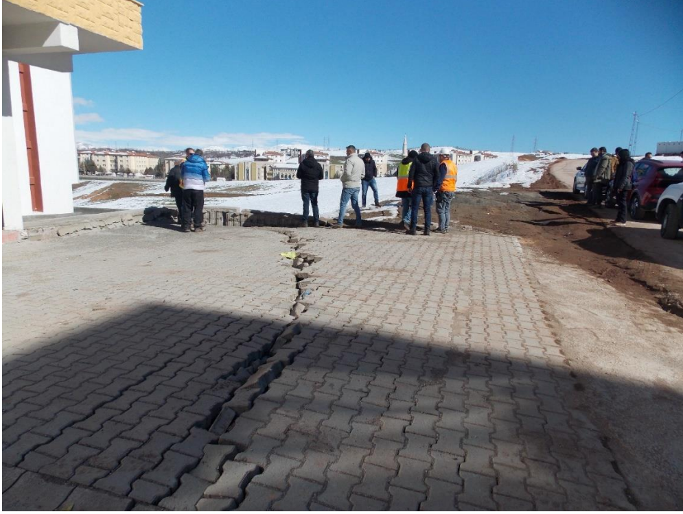
Şekil 4.12 Adıyaman Gölbaşı ilçesi TOKİ konutları civarındaki şevde yerleşik binalarda ve istinat duvarlarının arkasında açılmalar.
