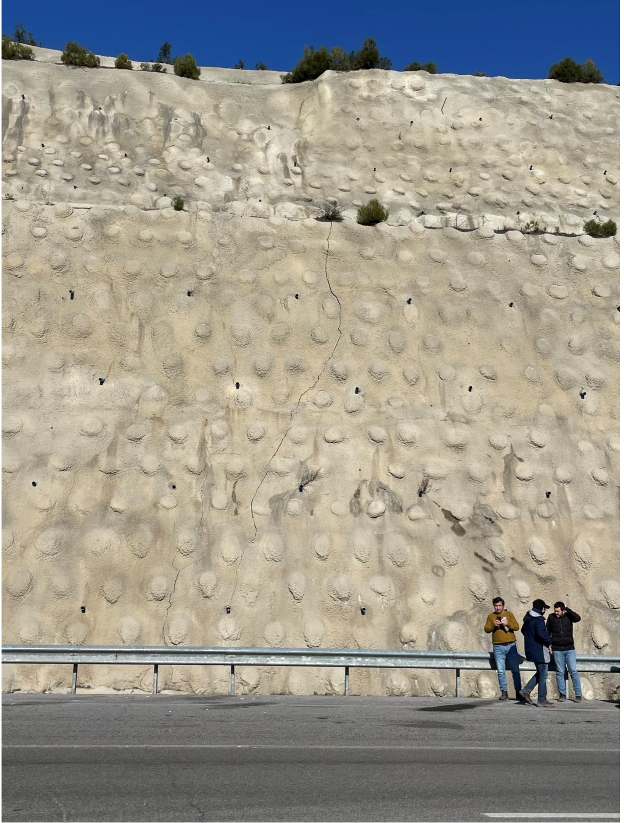
Şekil 4.20 Gaziantep İslâhiye ilçesi Fevzipaşa mahallesi girişi bölünmüş stabilize edilmiş yol yarmalarında çatlaklar
