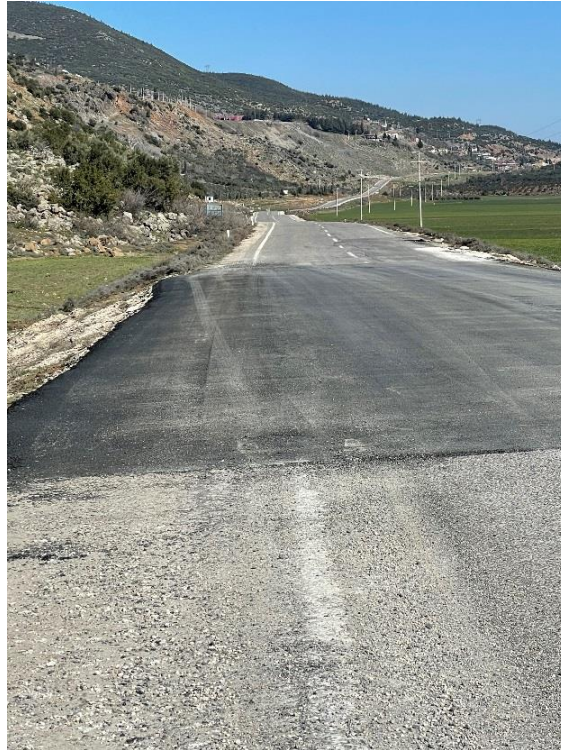
Şekil 4.32 Gaziantep İslâhiye ilçesi Türkbahçe mahallesi civarı fay atımı dolayısı ile yoldaki deformasyonlar
