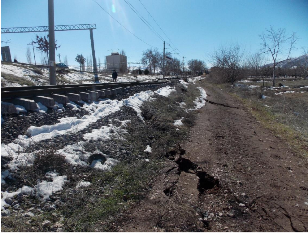
Şekil 4.35 Adıyaman Gölbaşı ilçesi yumuşak kil tabakadaki yanal deformasyonlar sonucu demiryolu hattının altının boşalması
