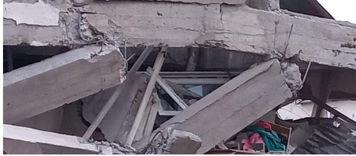
Şekil 5.5 Beton- donatı sıyrılması problemi
