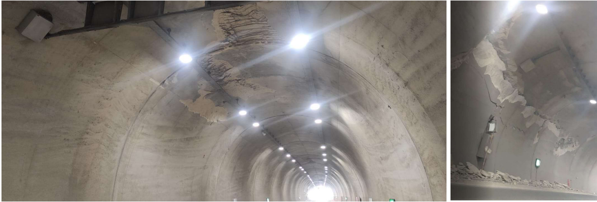
Şekil 13 Erkenek Tüneli Meydana Gelen Hasarlar
