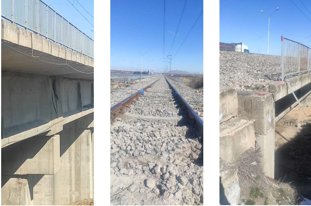
Şekil 15 Tohma Köprüsünde meydana gelen hasarlar
