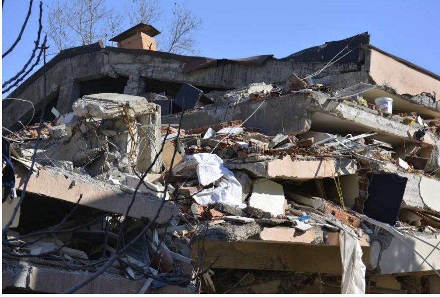
Şekil 3 Yıkıma Uğrayan 2000 Öncesi Betonarme Yapı
