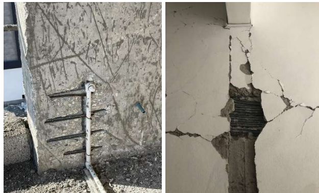
Şekil 8 Tesisat işçiliği esnasında paspayının kaldırılması (solda), Elektrik kondüvit uygulaması sırasında zarar görmüş betonarme kesit (sağda)
