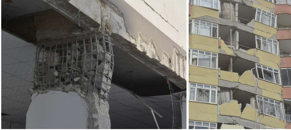
Şekil 7 Hatalı ve yetersiz etriye imalatları (solda), dolgu duvar hasarı (sağda)
