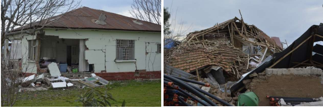
Şekil 9 Kısmi göçme yaşanmış bir yığma yapı(solda), büyük oranda göçmüş kerpiç yapı(sağda)
