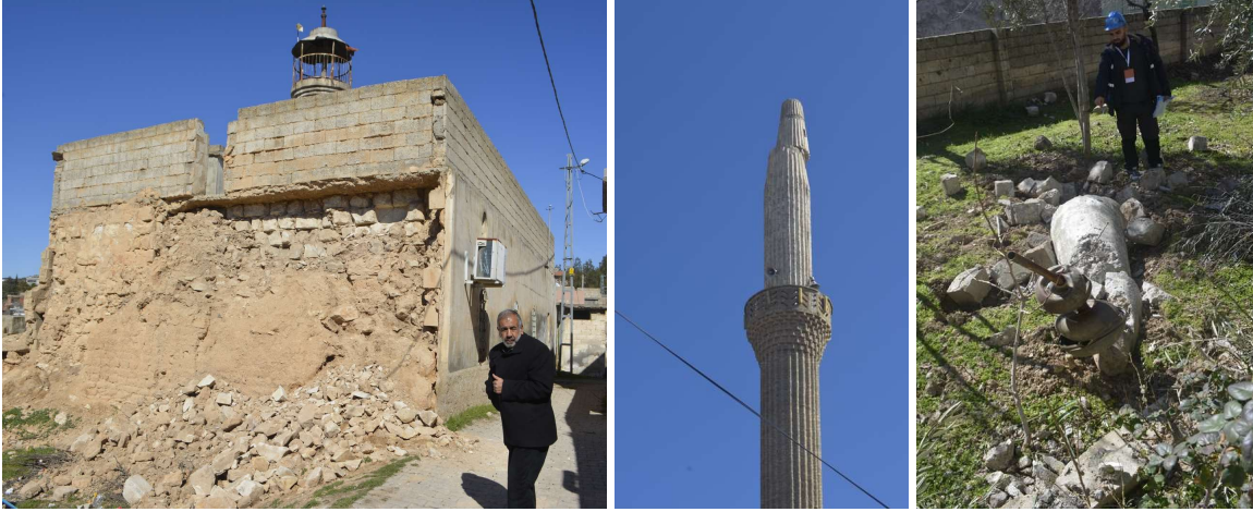
Şekil 10 Kısım göçme hasarı almış tarihi bir cami yapısı (solda), Deprem Bölgesinde Sıkça gözlemlenen minare hasarları(orta-sağ)
