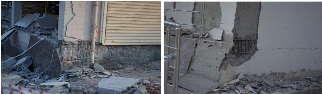
Şekil 6 İşçilik Hataları Sebebiyle Ortaya Çıkan Hasar Durumları- Bodrum perdelerinden kolonlara geçen kesitlerdeki enine donatı yetersizliği
