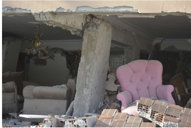
Şekil 5 Tasarım Etkisi ile Ortaya Çıktığı Öngörülen Hasar Durumu
