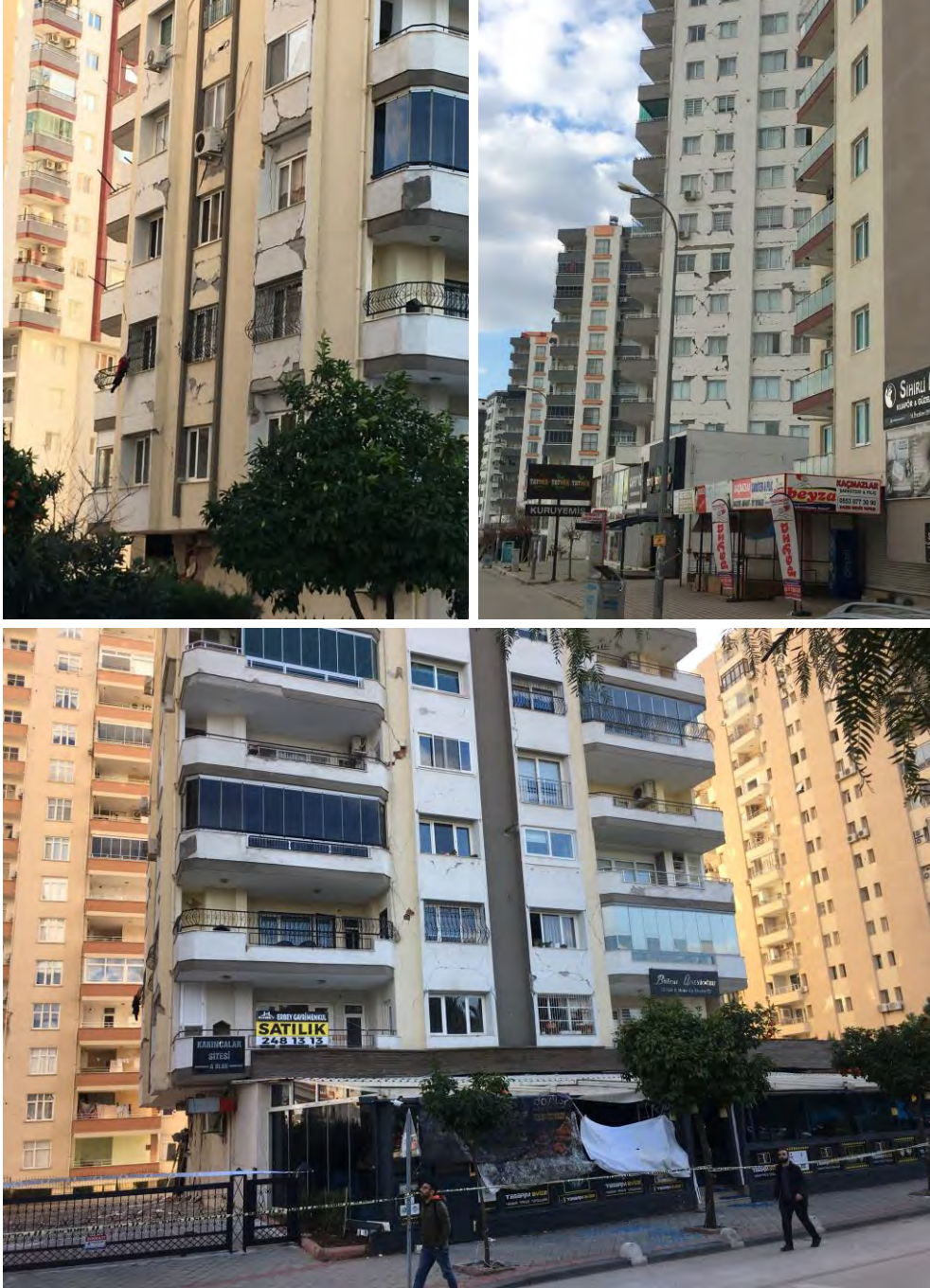
Şekil 12. Adana’da gözlemlenen dış cephe çatlakları ve bölme duvar ayrılımları
