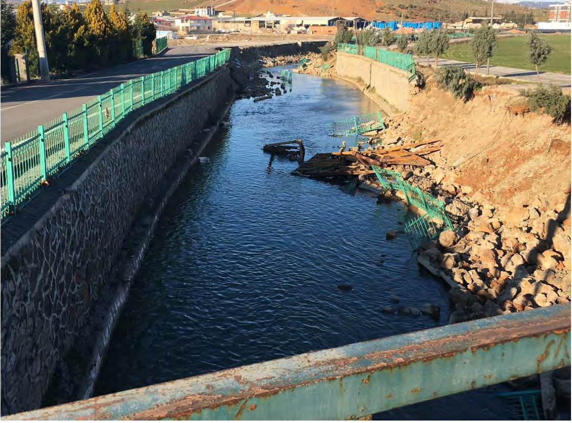
Şekil 99. Türkoğlu merkezinde dere kanalı boyunca yanıl yayılmalara bağılı olarak dayanma yapılarında hasarlar
