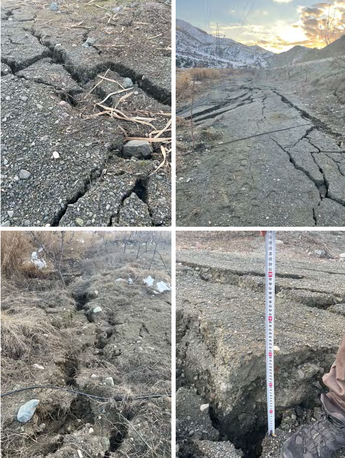
Şekil 39. Malatya – Adıyaman yolu, sıvılaşma sebepli hasarlar (37,86523°N 37,77102°E)
