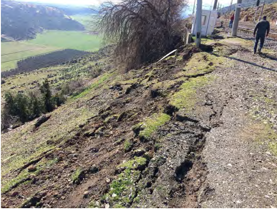
Şekil 60. İstasyonun doğusundaki yarma boyunca büyük tansiyon çatlakları ve heyelan oluşumları
