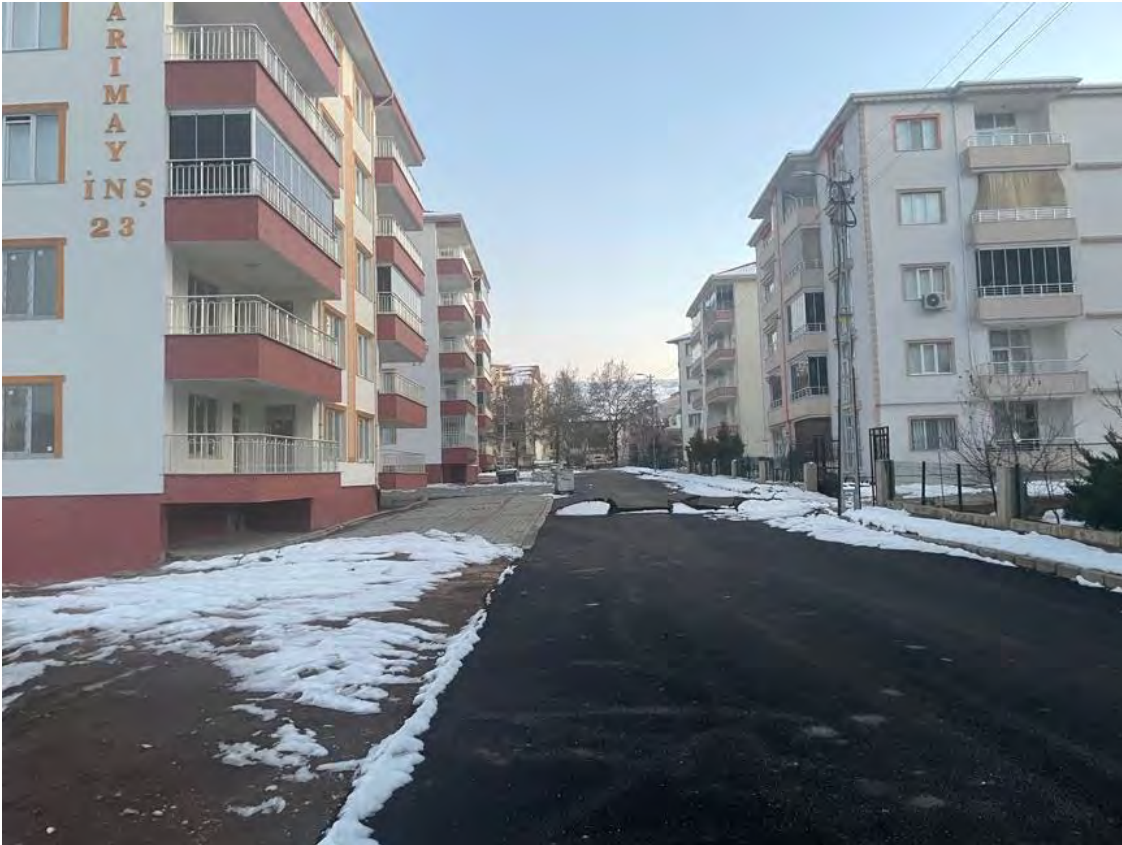
Şekil 22. Sıvılaşma sebebi ile temel zeminlerinde oturmalar görülen binalar (Adıyaman - Gölbaşı)
