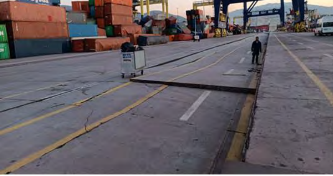
Şekil 83. Limanda meydana gelen geniş çatlaklar, ayrılmalar ve derin oturmalar
