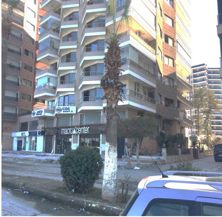
Şekil 13. Adana’da gözlemlenen zemin kattaki kolonda mafsallaşma
