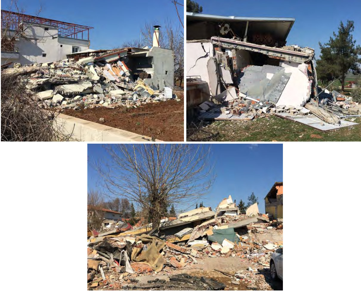
Şekil 87. Kahramanmaraş kırsal alan yıkım görüntüleri
