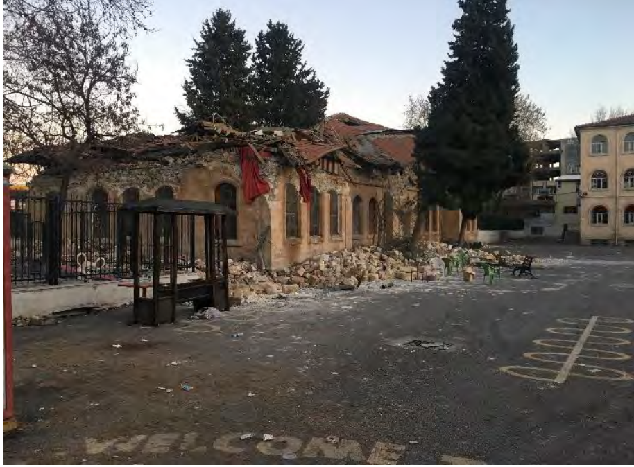
Şekil 21. Yığma yapılarda gözlenen çatı hasarı
