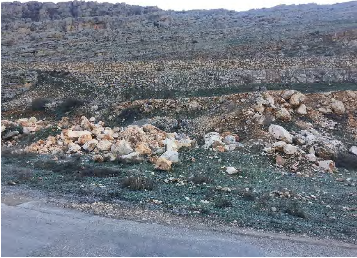
Şekil 105. Çöçelli mahallesi mevkiinde yol güzergahındaki şevlerde kaya düşmesi
