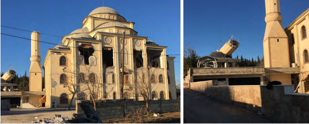
Şekil 90. Hasar gören cami ve yıkılan minare örneği
