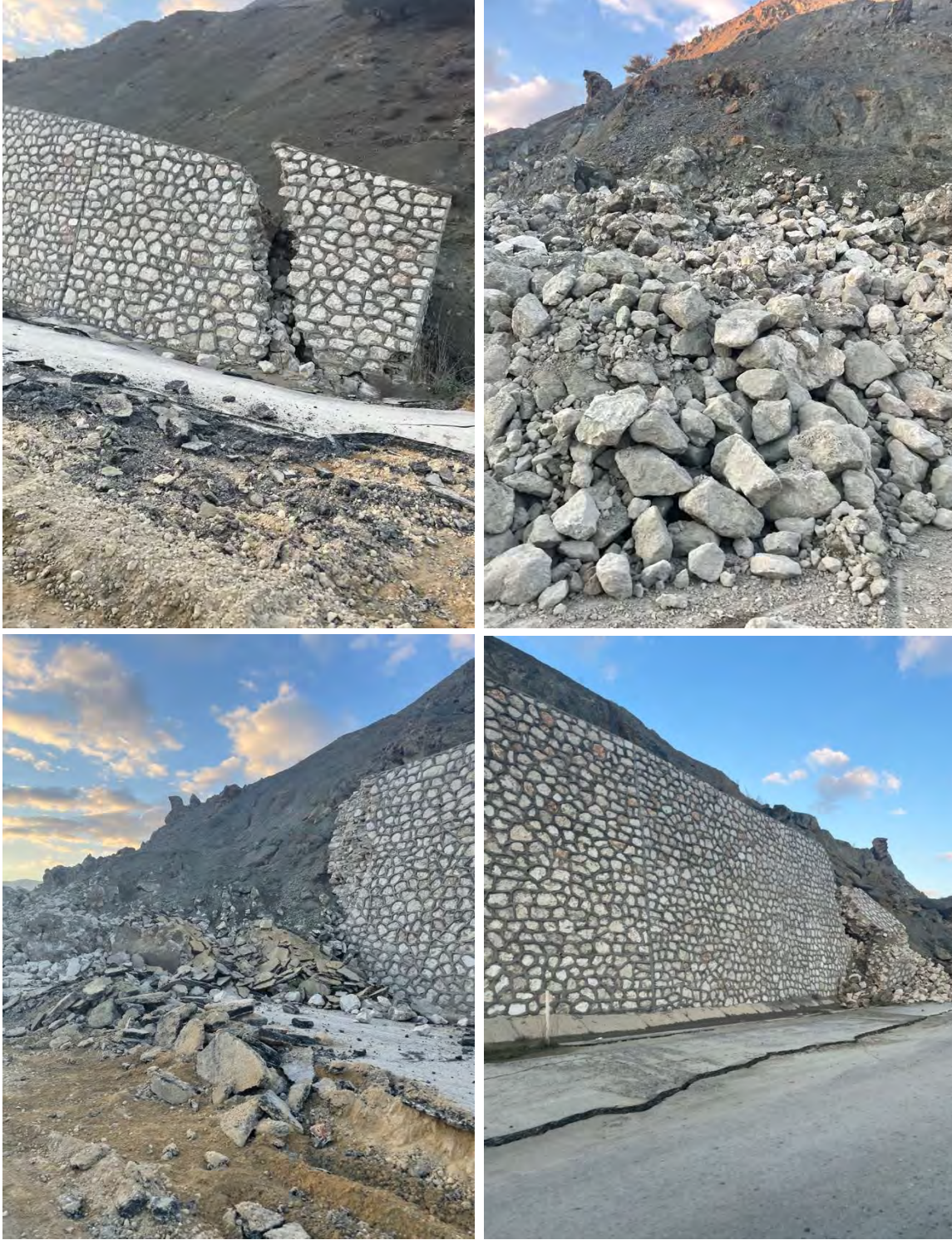
Şekil 40. Malatya – Adıyaman yolu, istinat yapılarındaki hasarlar (37,86346°N 37,76782°E)
