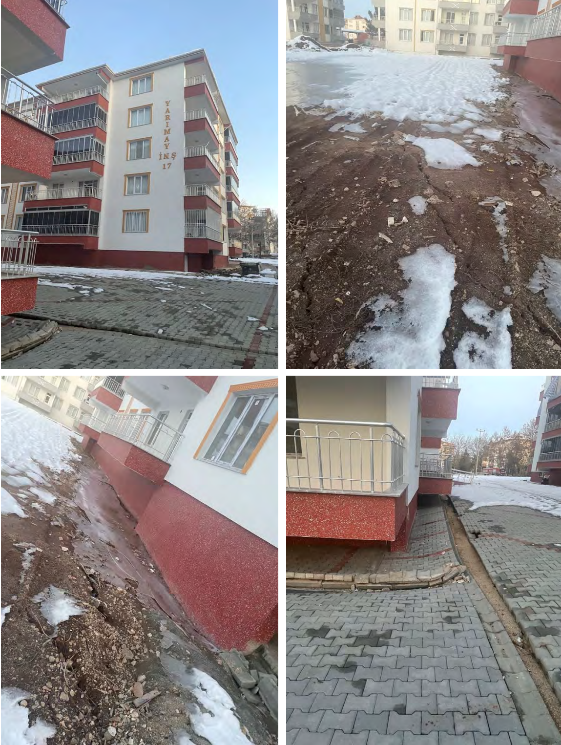
Şekil 23. Sıvılaşma sebebi ile binalarda oluşan yanıl deformasyonlar ve oturmalar 1 (Adıyaman - Gölbaşı)
