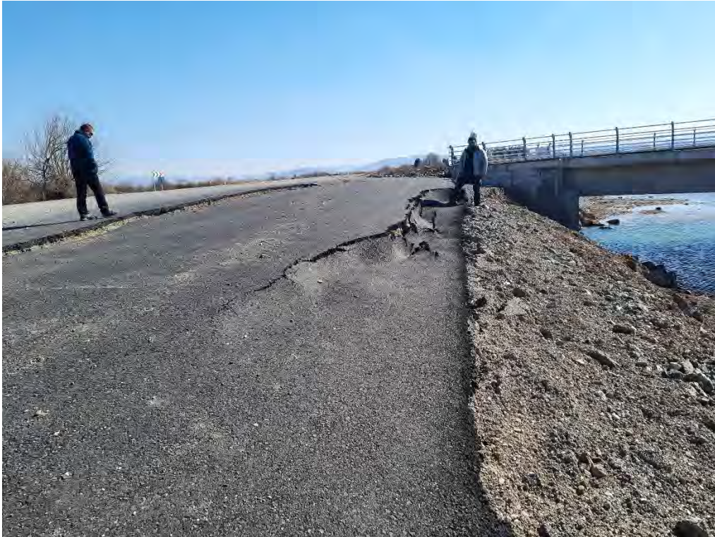
Şekil 96. Türkoğlu bölgesinde baraj yolu geçkisinde yanal yayılmalar
