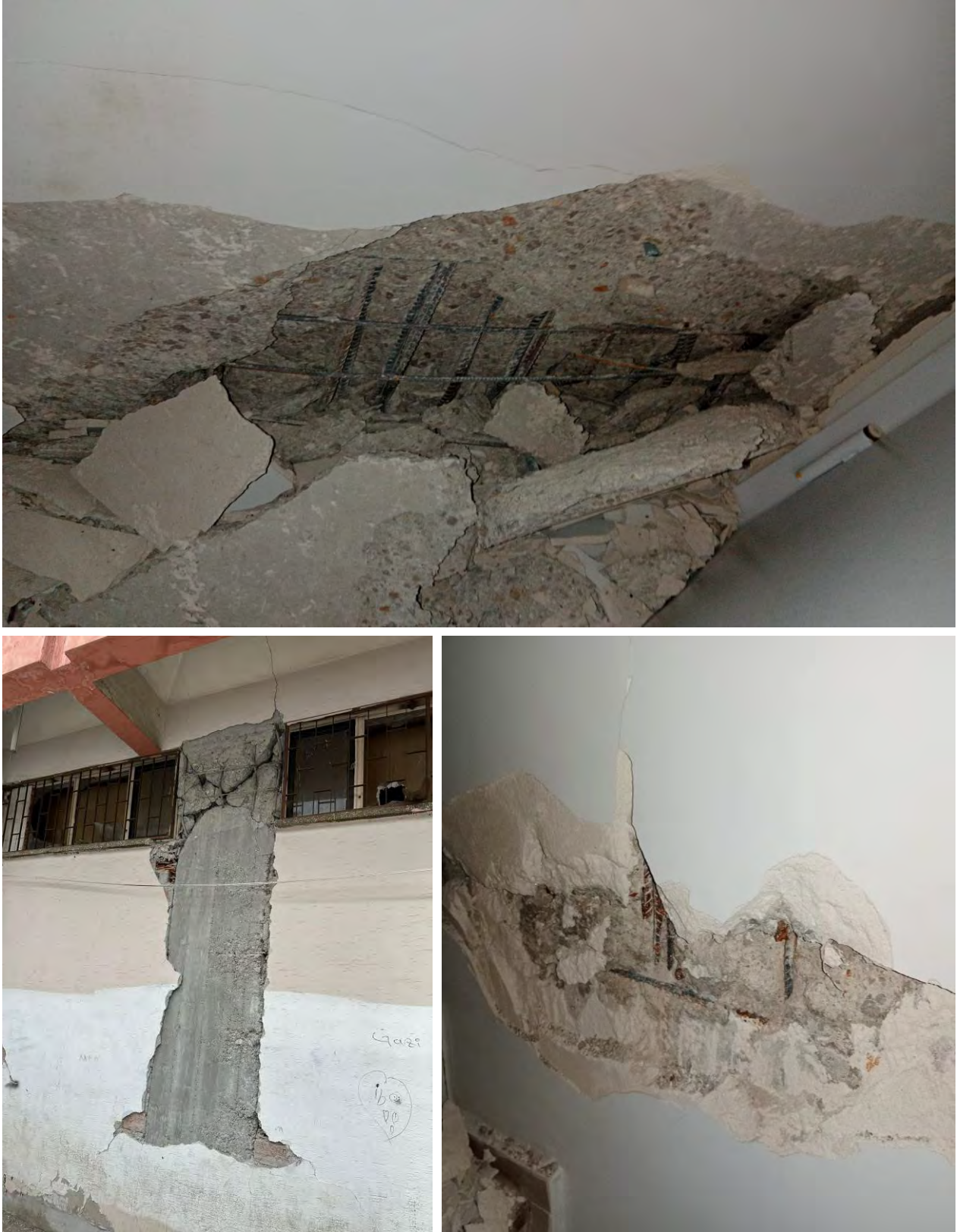
Şekil 112. Perde hasarları ve kısa kolon hasarı
