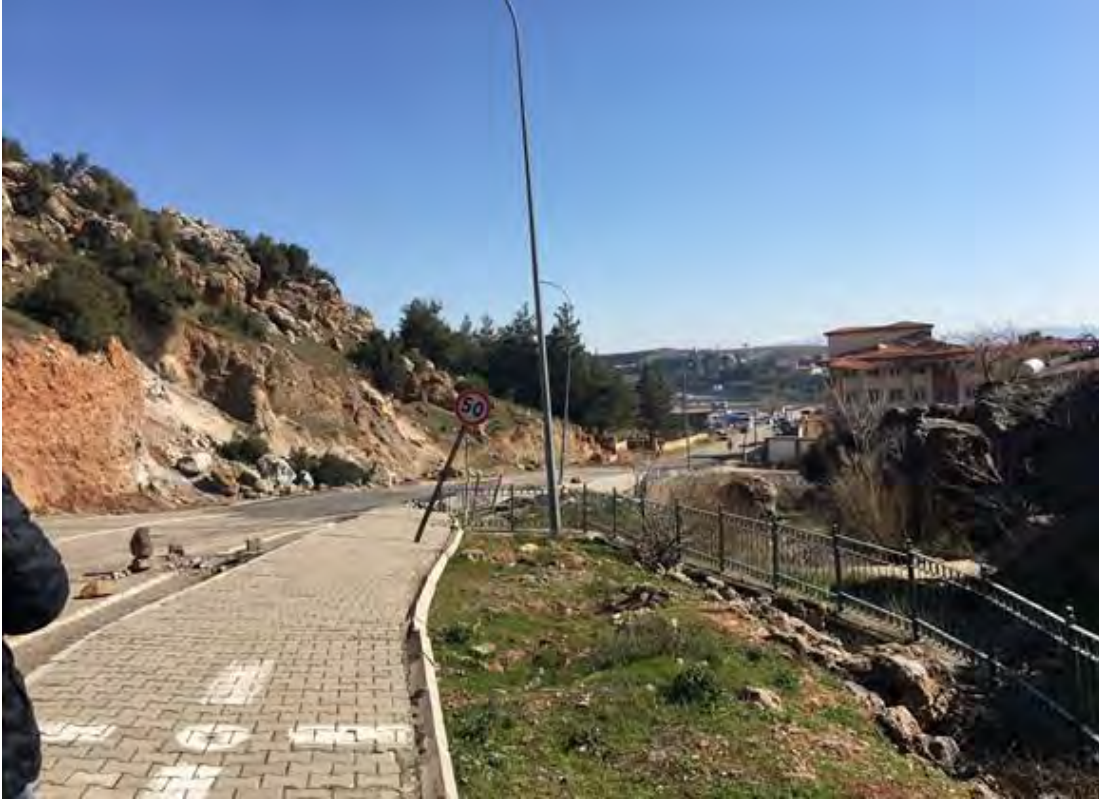
Şekil 57. Fevzipaşa mahallesinde yol ve dere kanalı boyunca kaya düşmeleri
