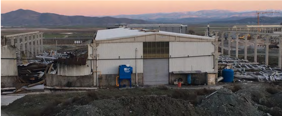
Şekil 91. Sanayi yapılarında görülen hasarlara örnek
