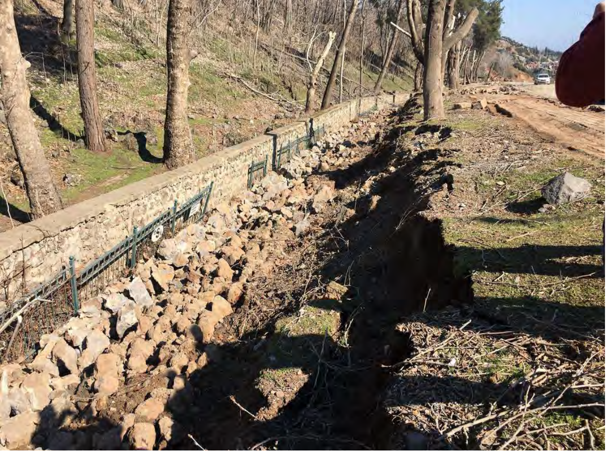
Şekil 58. Islahiye'nin Fevzipaşa mahallesinde dere kanalı boyunca yanal yayılmalara bağlı hasarlar
