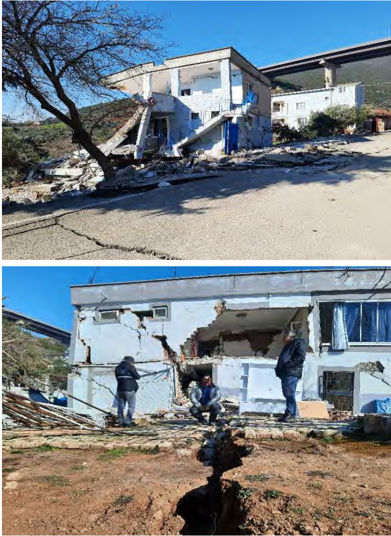
Şekil 53. Yüzey faylanması nedeniyle evlerde oluşan büyük hasarlar
