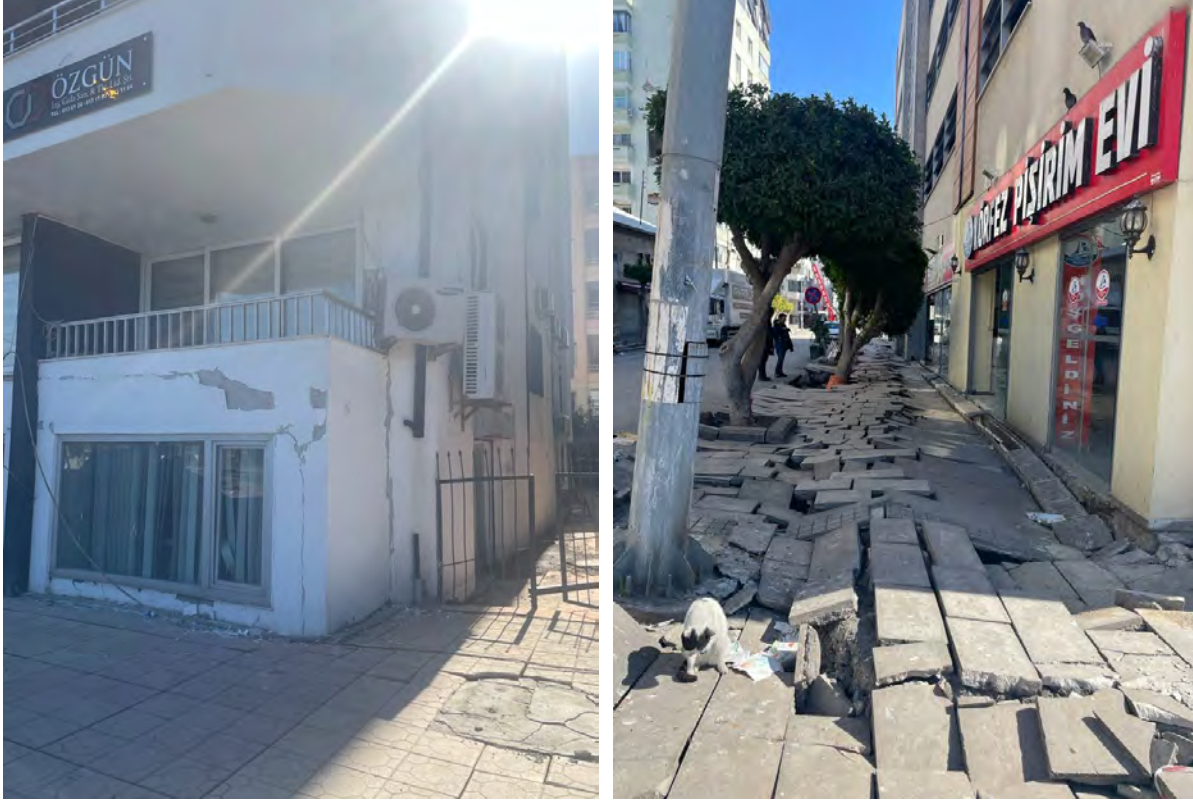
Şekil 79. İskenderun Hatay, sivilaşmaya bağlı oturma ve yüzeyde meydana getirdiği deformasyonlar
