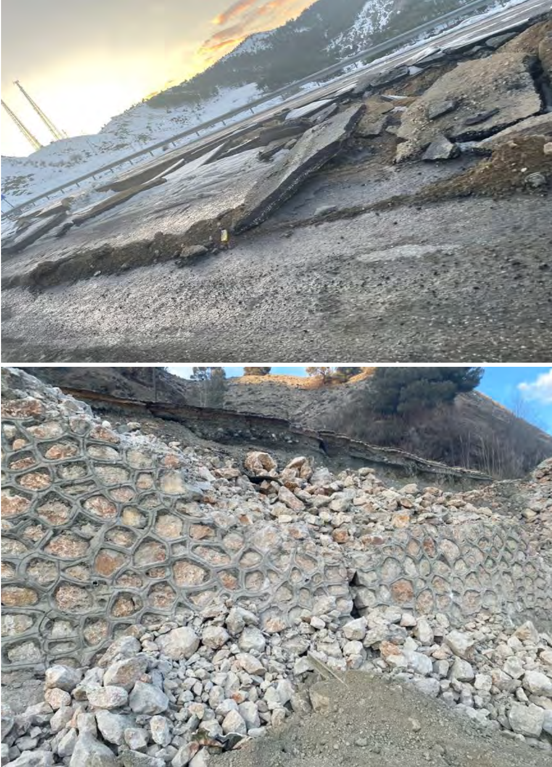
Şekil 41. Malatya – Adıyaman yolu, yol üzerinde ve istinat yapısında hasarlar (37,82373°N 37,67904°E)
