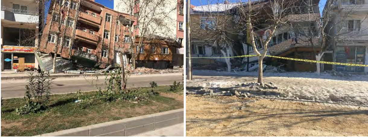
Şekil 19. Zemin katı ticarethane olan, yumuşak kat kaynaklı yıkımlara örnekler
