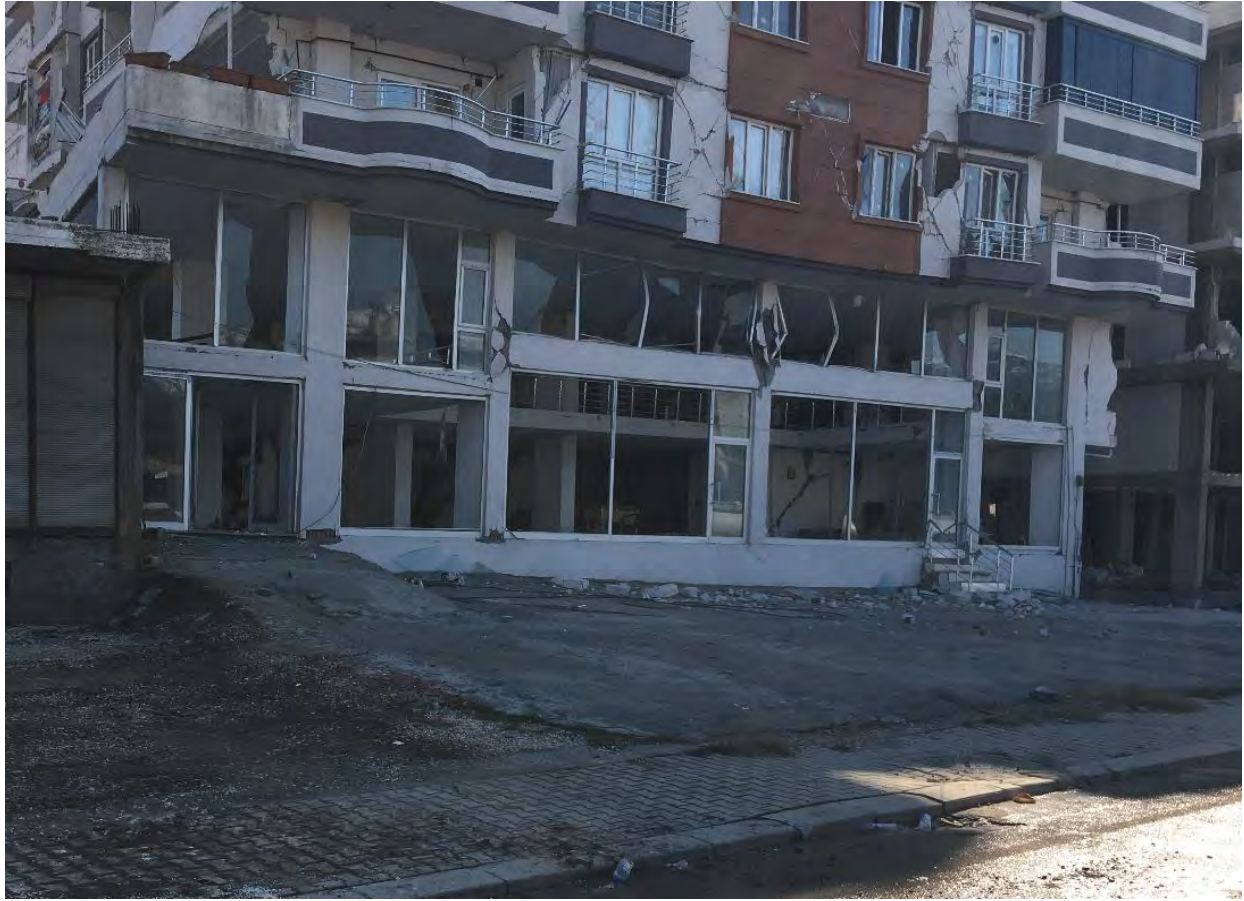
Şekil 51. Kısa kolon etkisi sonucunda oluşan hasarlar
