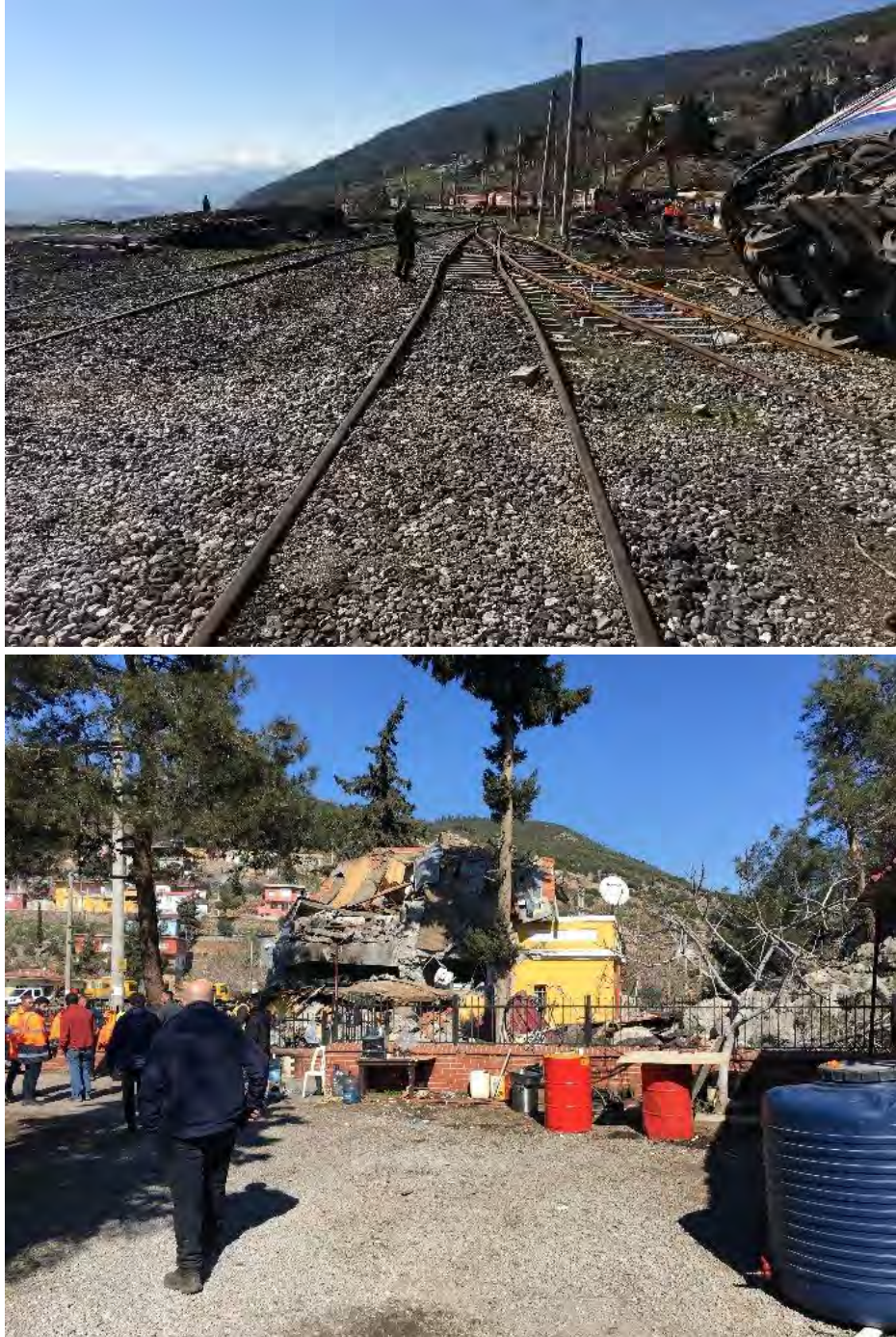
Şekil 59. Fevzipaşa tren garı yüzey faylanması ve buna bağlı hasarlar
