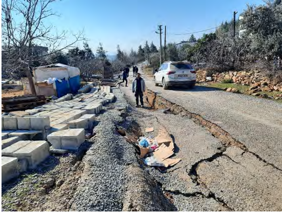
Şekil 54. Nurdağ ilçesinde yol güzergahında yüzey faylanması nedeniyle büyük deformasyonlar ve oturmalar
