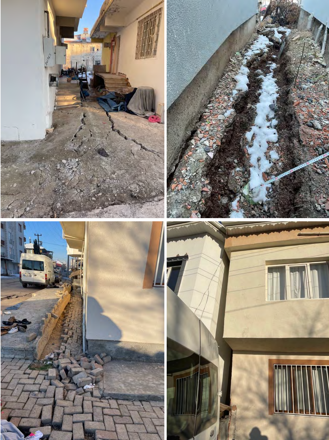
Şekil 32. Sıvılaşma sebebi ile binalarda görünen yanal deformasyon, oturma ve eğilmeler
