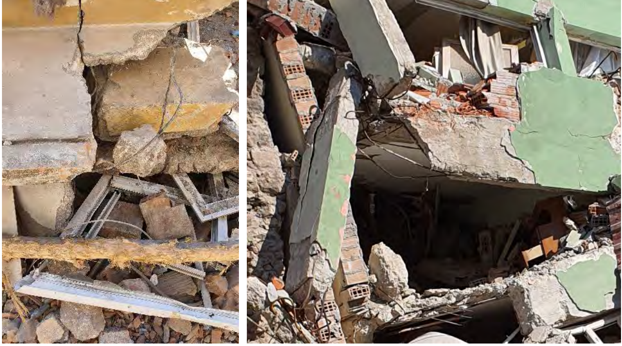
Şekil 68. Düz donatı kullanımının yarattığı aderans problemleri
