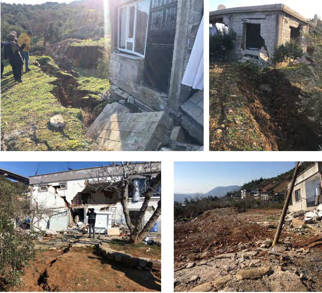
Şekil 50. Yüzey fay kırığı sonucu binalarda oluşan hasarlar
