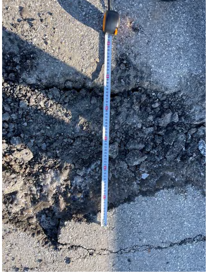
Şekil 95. Göksun/Maraş yol hasarı
