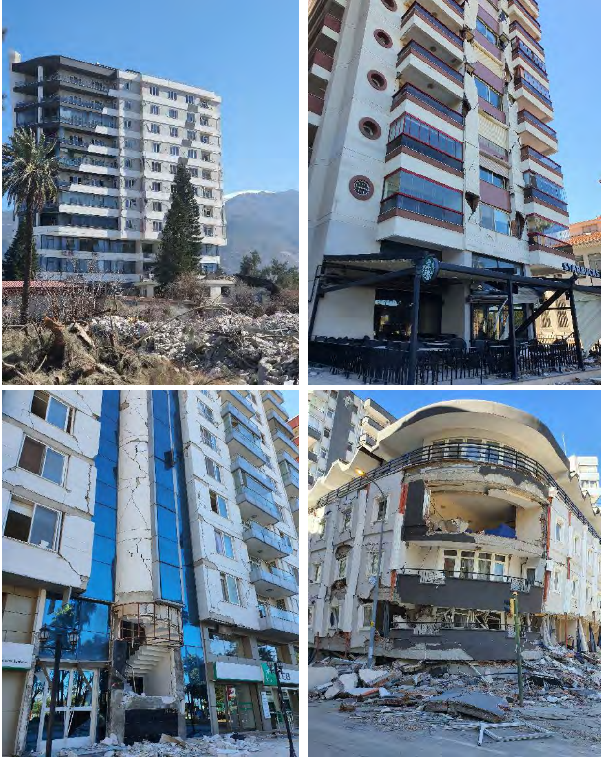
Şekil 67. Yumuşak kat düzensizliği ve ağır çıkmalar sonucunda oluşan hasarlar
