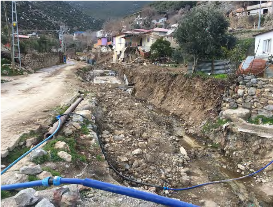
Şekil 61. Islahiye'nin Arpalı mahallesinde dere kanalı boyunca yanal yayılmalara bağlı hasarlar
