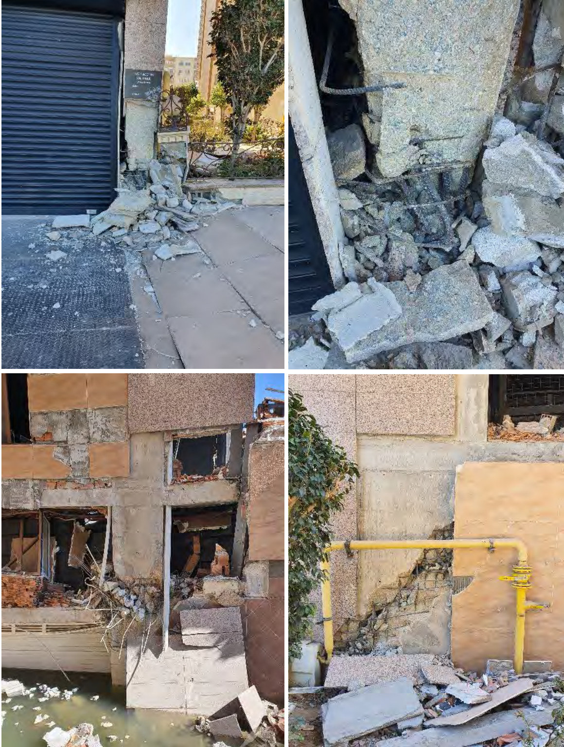
Şekil 70. Gözlemlenen perde duvar kesme ve kolon hasarları
