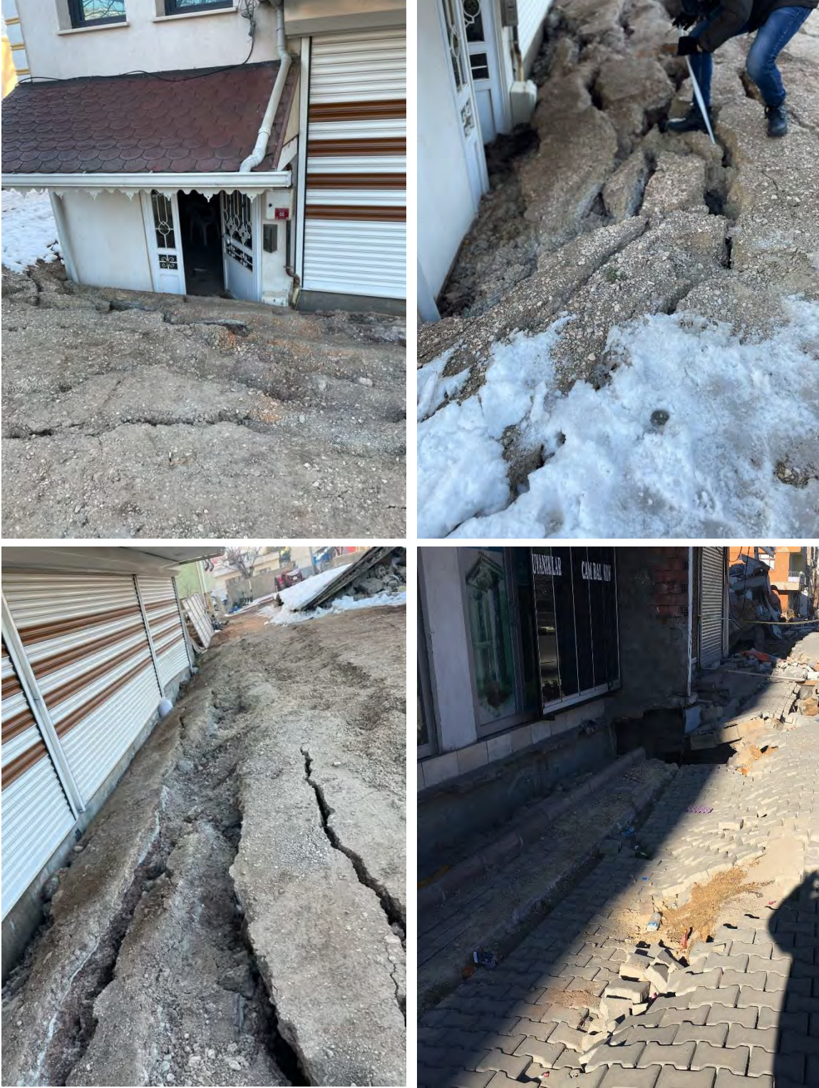
Şekil 25. Sıvılaşma sebebi ile binalarda oluşan yanıl deformasyonlar ve oturmalar 3 (Adıyaman - Gölbaşı)
