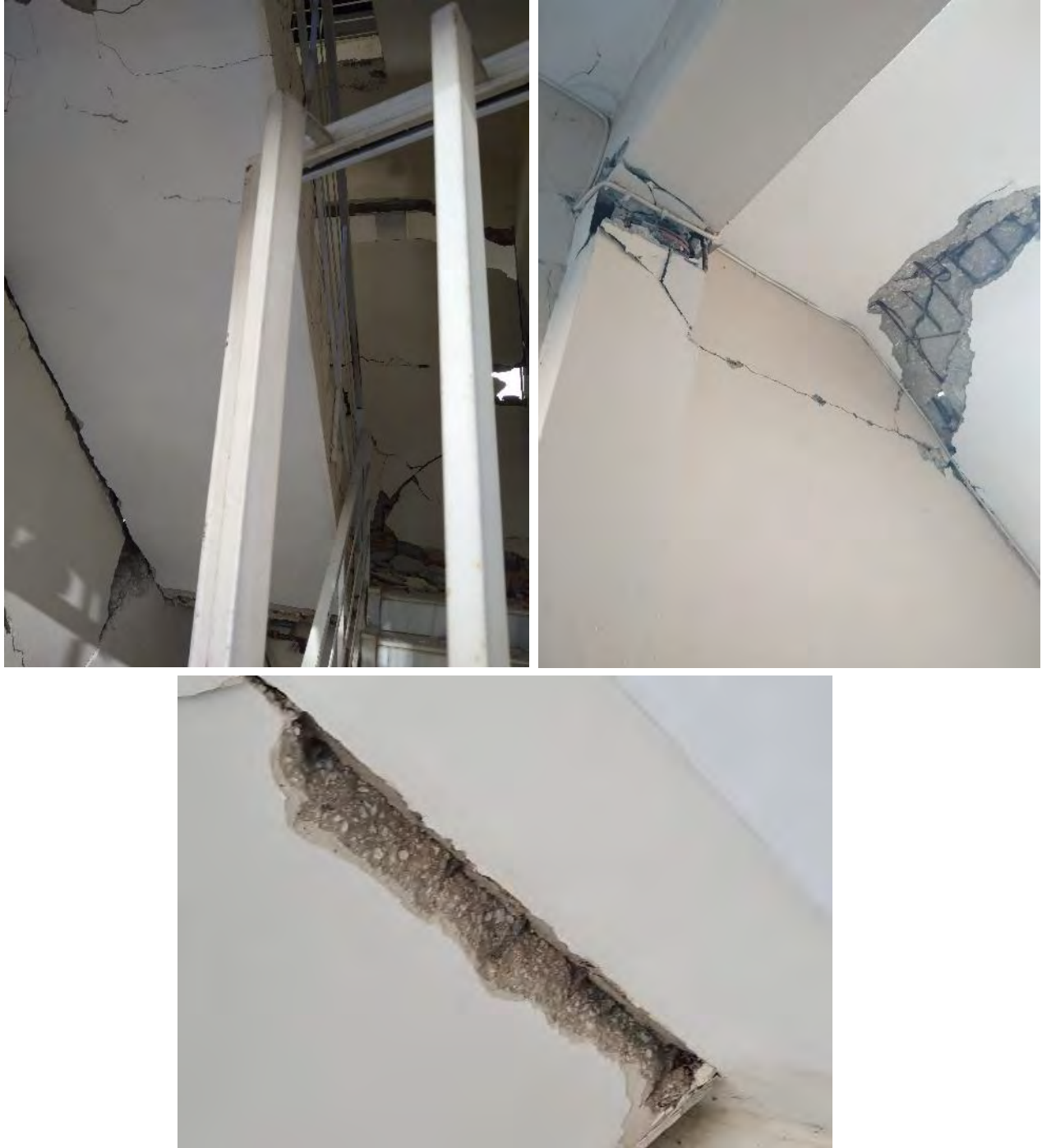
Şekil 69. Gözlemlenen merdiven hasarları
