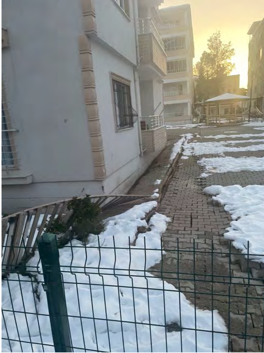
Şekil 24. Sıvılaşma sebebi ile binalarda oluşan yanal deformasyonlar ve oturmalar 2 (Adıyaman - Gölbaşı)
