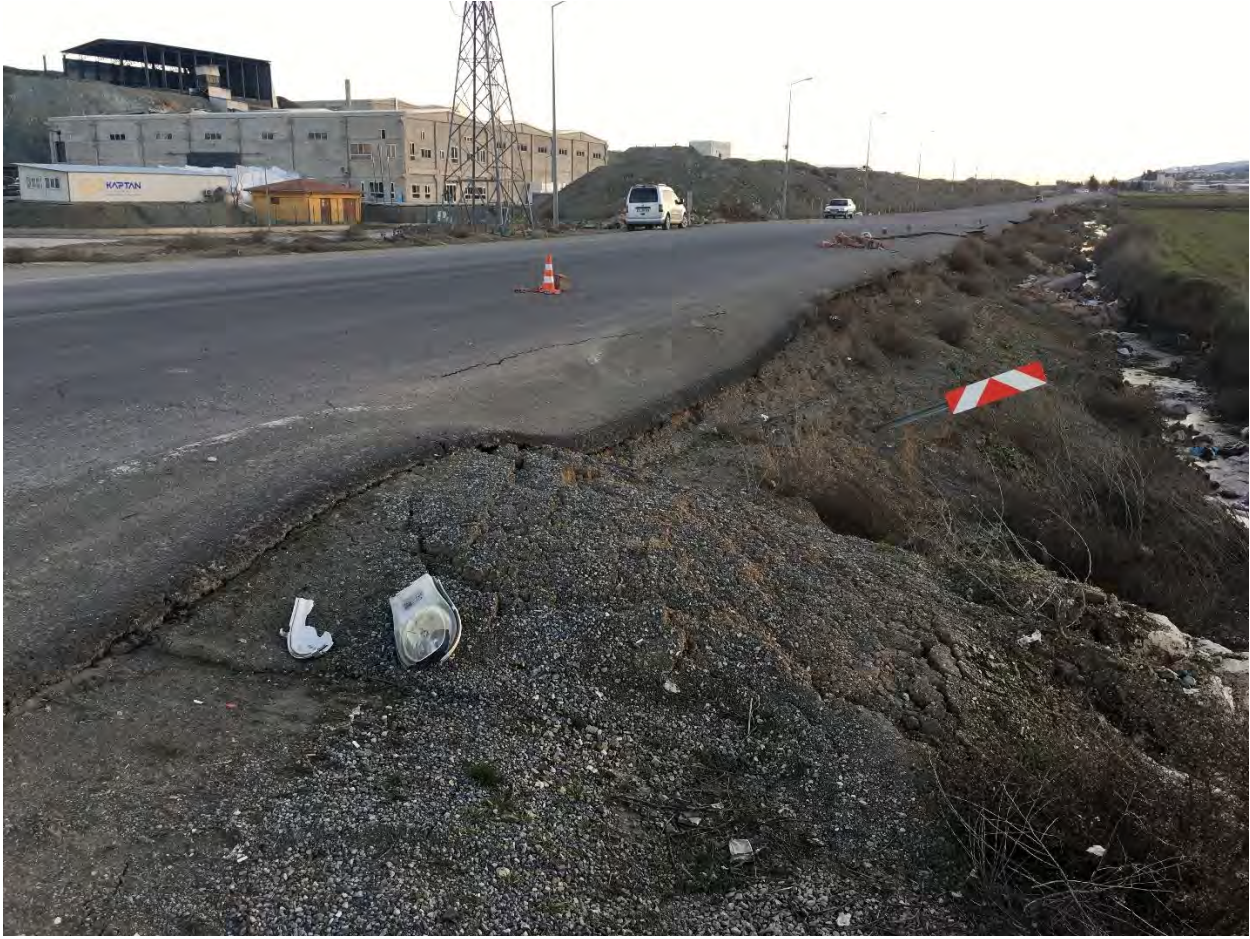
Şekil 100. İlçenin güney sanayi bölgesinde yanal yayılmalara bağlı olarak yol kaplamasında dalga şeklinde deformasyonlar
