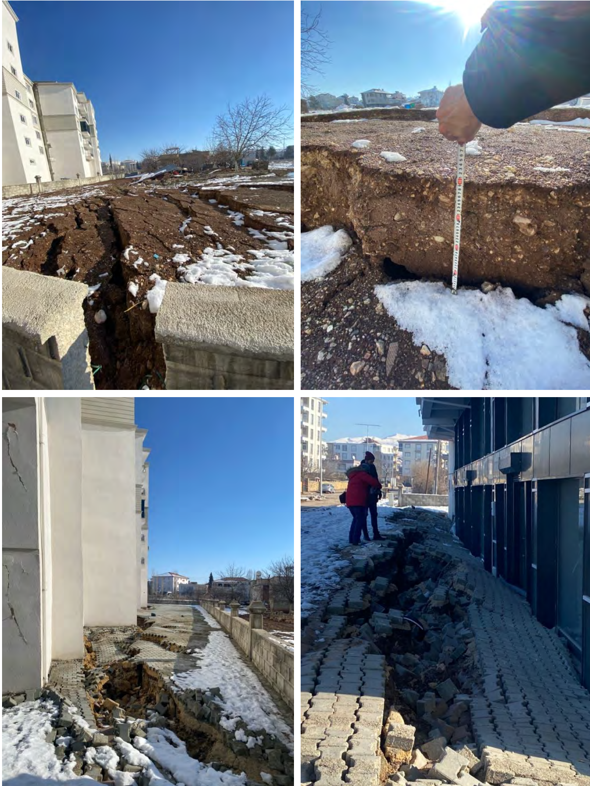
Şekil 29. Adıyaman ili Gölbaşı ilçesinde gözlemlenen bina oturma ve yanıl deformasyon örnekleri
