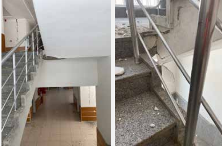
Şekil 3.23. Çelikhán Ortaokulu binası merdiven sisteminde oluşan yapısal hasarlar ve merdiven kaplamalarındaki hasarlar
