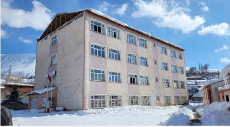
Şekil 3.27. Orta hasarlı Çelikhan Şehit Seyho Şişman Anadolu Lisesi betonarme binası, ahşap çatıda kalkan duvarı hasarı
