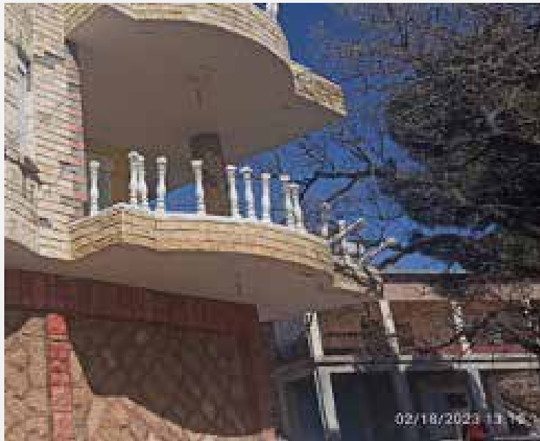
Resim 4. Prekast beton elemanlardan üretilen balkon parapetlerinde oluşan hasar.
