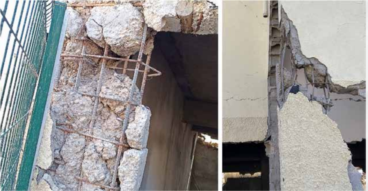
Resim 6. Uygun olmayan beton kalitesi ve donatı detaylarına örnek görseller.
