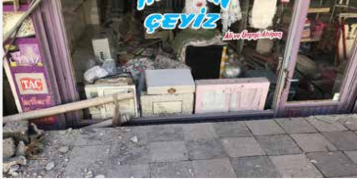
Resim 17. Temeli zemin içine doğru yaklaşık olarak 80cm yer deđiřtiren bina
