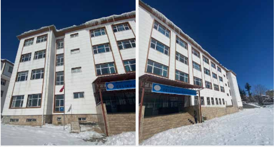
Şekil 3.21. Çelikhán Ortaokulu binası, dış cephe kaplamalarında oluşan dökülmeler
