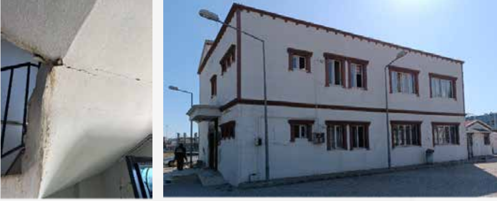
Şekil 3.51. Merdiven hasarı ve duvar hasarı
