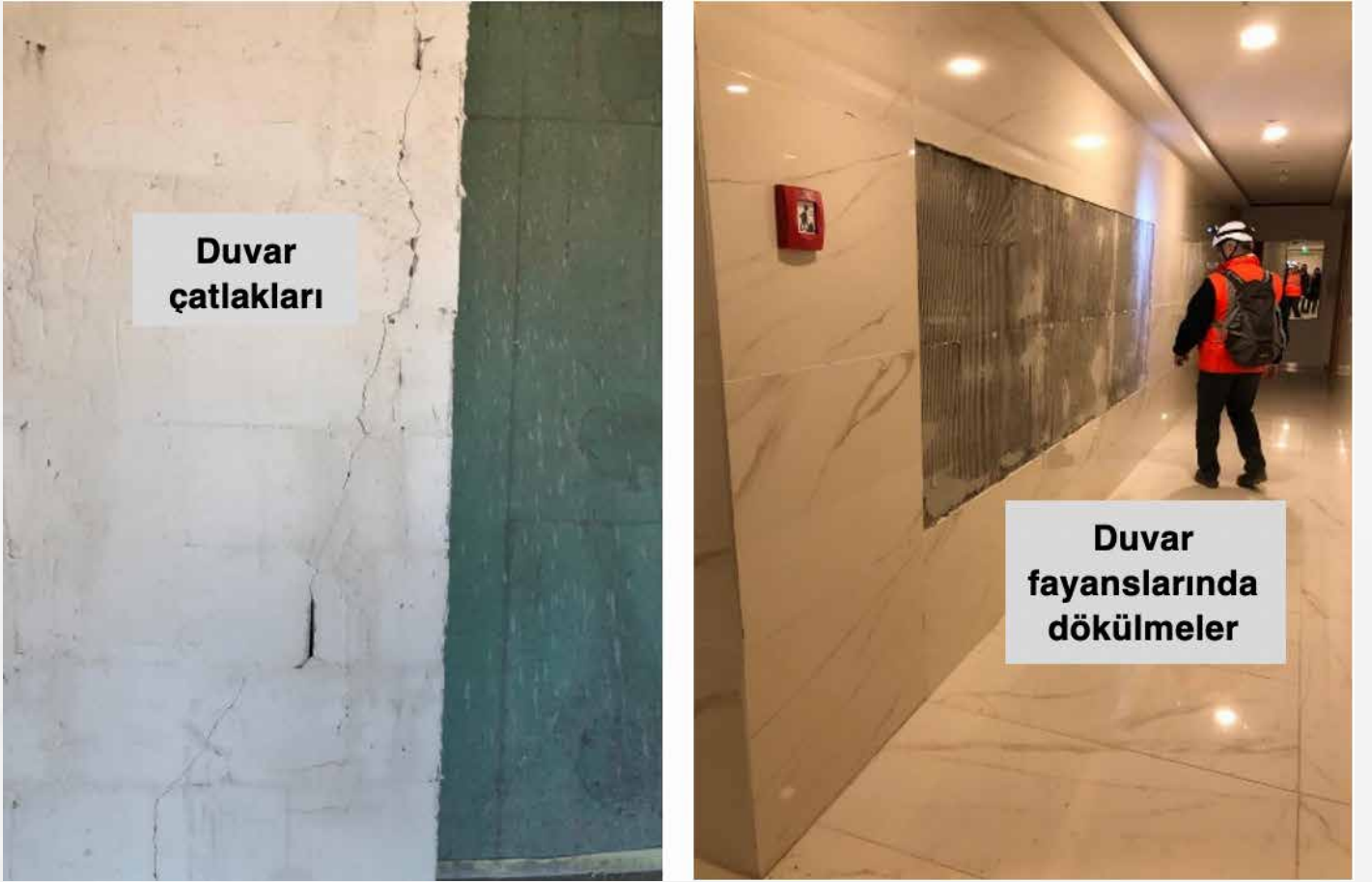
Şekil 3.73. Yüksek yapılarda meydana gelen hasarlar
