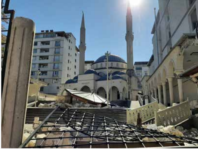
Resim 15. Pazarcık İlçesi D360 karayolu üzerinde bulunan Ulu Cami'de oluşan deprem hasarları
