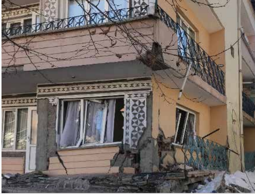
Resim 19. Kısa kolon etkisi nedeniyle oluşan kolon hasarı
