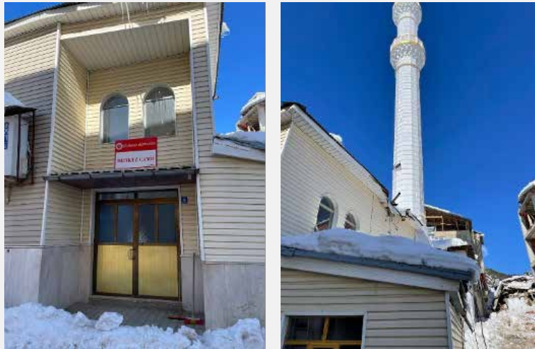
Şekil 3.62. Merkez Cami ve hasarlı minaresi
