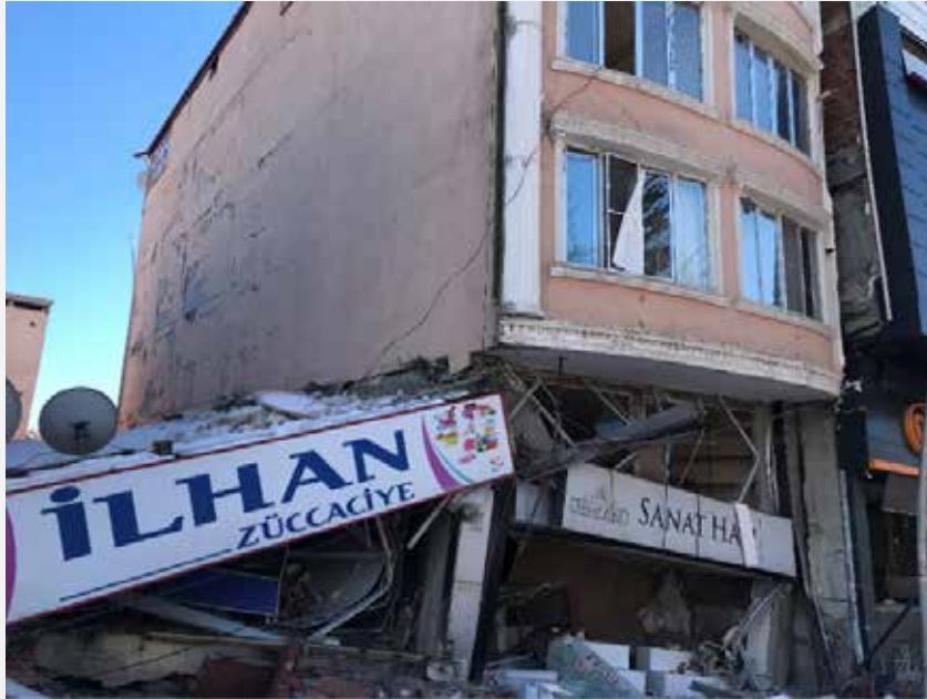
Resim 20. Yumuşak kat düzensizliği nedeniyle oluşan yapısal hasar
