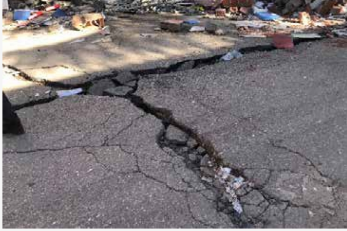
Resim 16. Asfalt zemin yüzeyinde oluşan hasar
