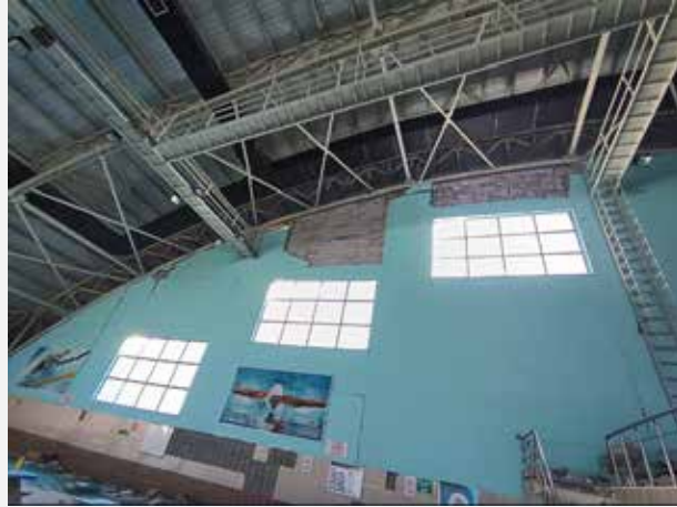
Şekil 3.52. Kalkan duvar hasarı
