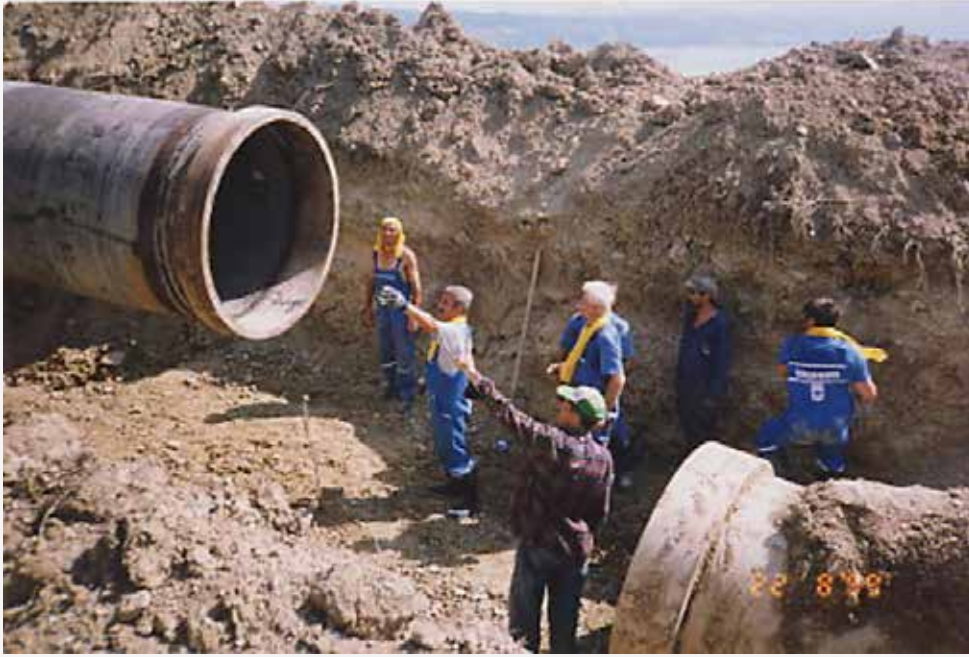
Şekil 5.2.4. Deprem sonrası hasar gören asbestli çimento boru hattında onarım ve yenileme çalışmaları (Ansal ve diğ., 2008).
