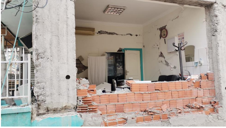
Şekil 5.12. Kalitesiz, özensiz imalat örneği: düşük kalite beton ve vibrasyonsuz beton yerleşimi
