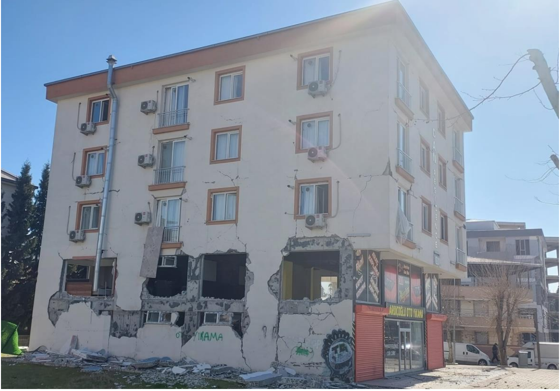
Şekil 5.23. Düzlem dışı dolgu duvar hasarı (2)
