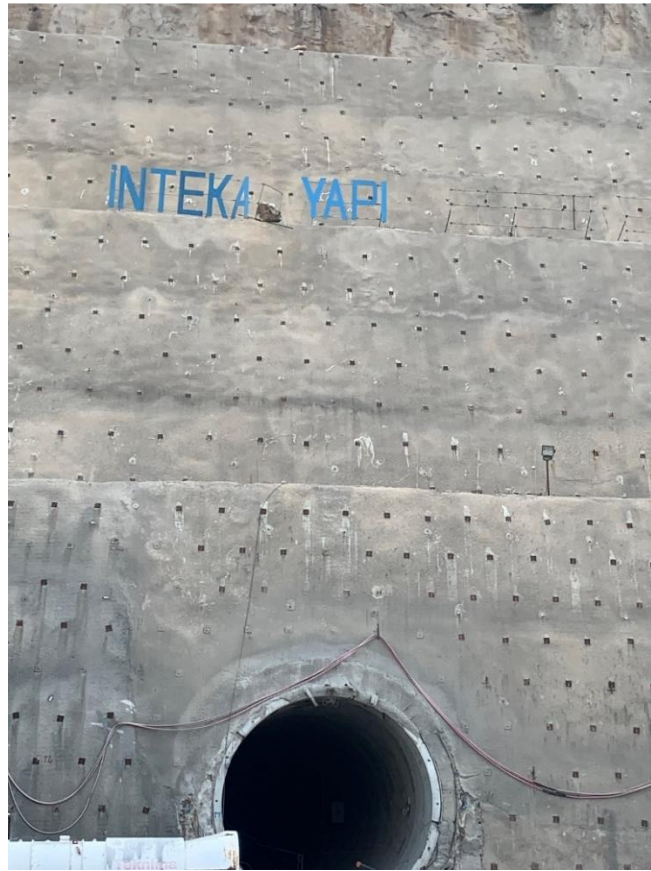
Şekil 4.17. Tünel portalında kaya düşmesine ait bir örnek
