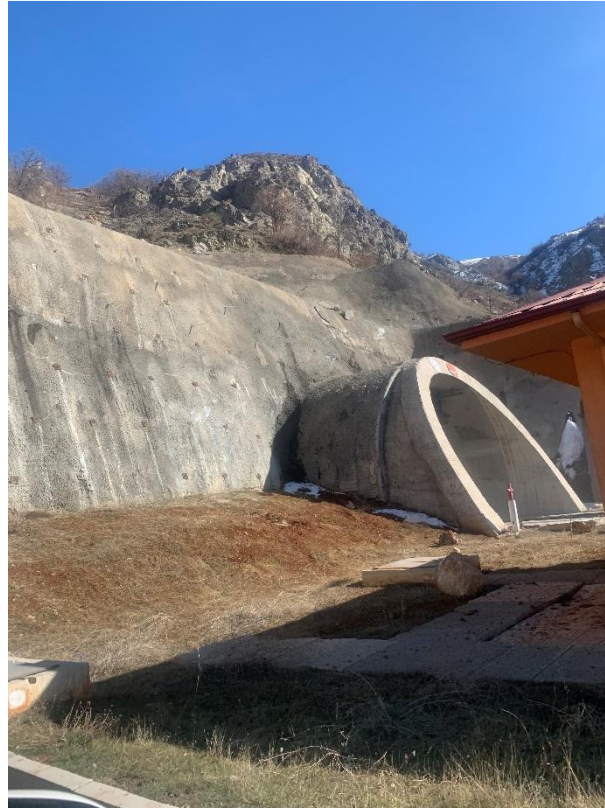
Şekil 6.1. Bir karayolu tüneli portalında gözlenen çatlaklar
