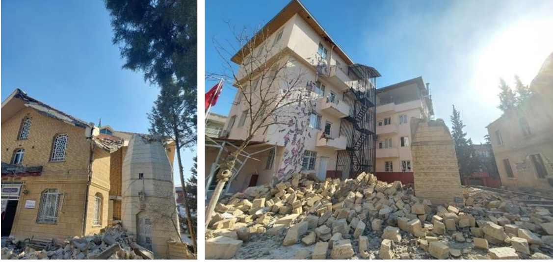
Şekil 5.26 Cami minaresi hasarları (1)
