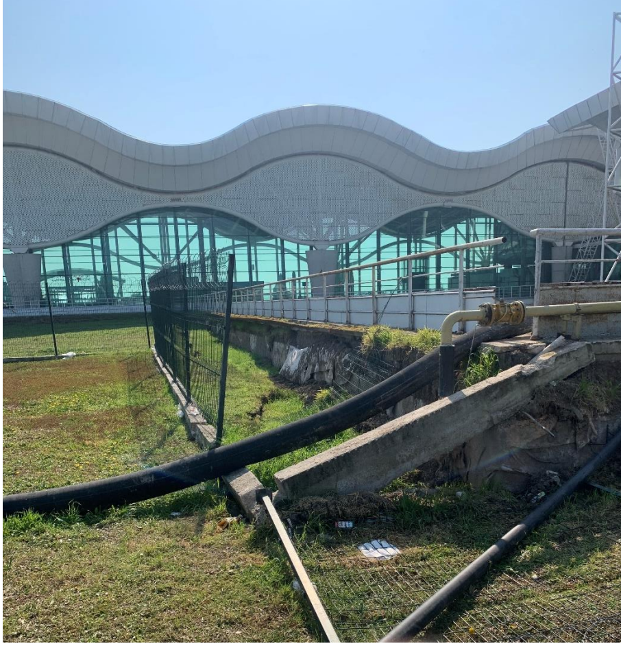
Şekil 4.13. Hatay Hava Limanı Terminal Binası ve çevresinde gözlenen zemin deformasyonları
