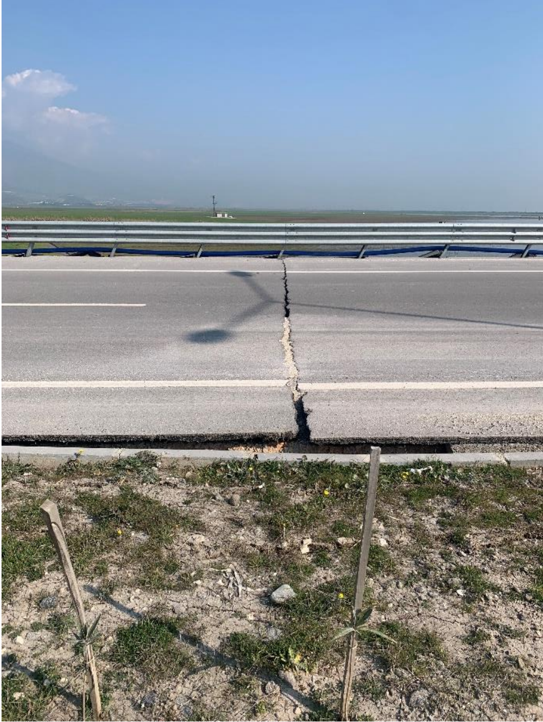
Şekil 6.5. Karayolu köprüsü hasarı
