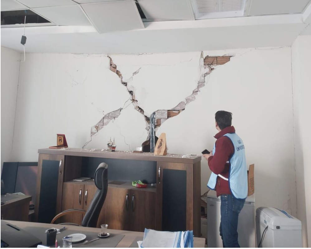
Şekil 5.25. Düzlem içi dolgu duvar hasarı (2)
