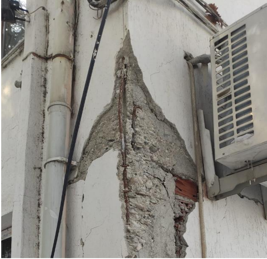
Şekil 5.11. Kolon-kiriş birleşim bölgesinde yetersiz etriye nedeniyle burkulmuş boyuna donatı, düşük kalite beton ve vibrasyonsuz beton yerleşimi
