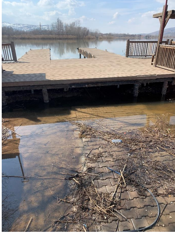
Şekil 4.2. Gölbaşı ilçesinde yanal yayılma sonucu gözlenen çökme
