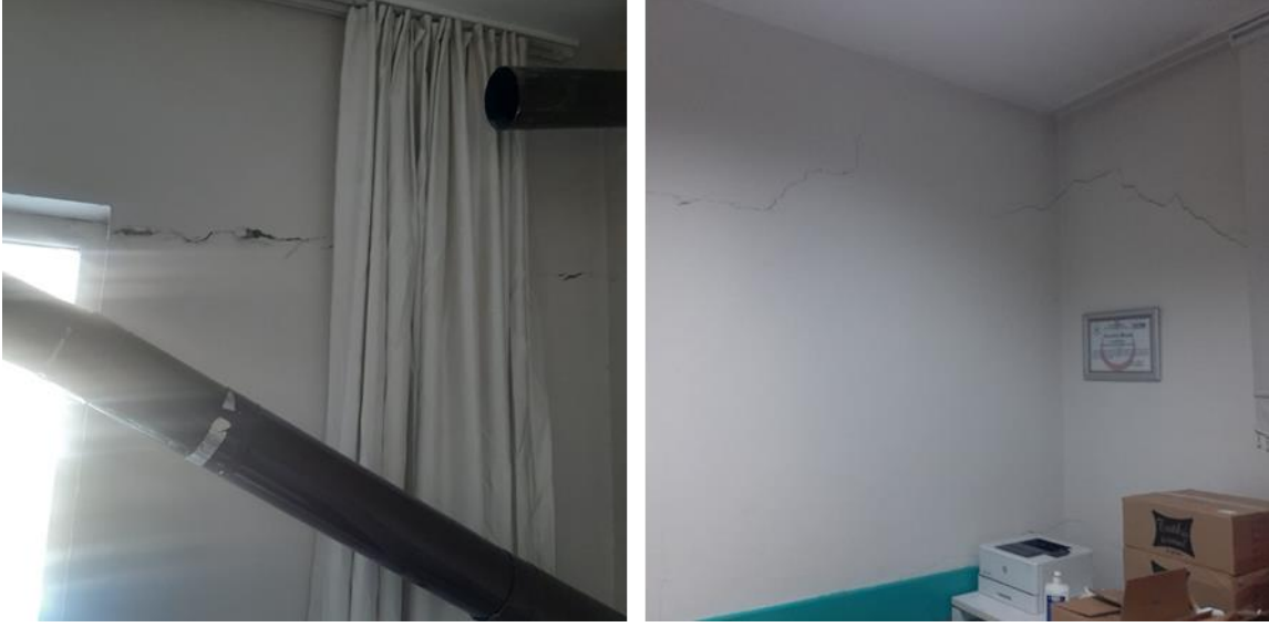
Şekil 5.20. Yığma yapı hasarları (2)
