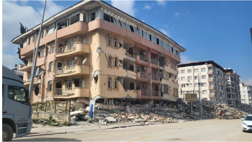
Şekil 5.3. Yumuşak kat oluşumu nedeniyle göçen konut türü yapı (1)
