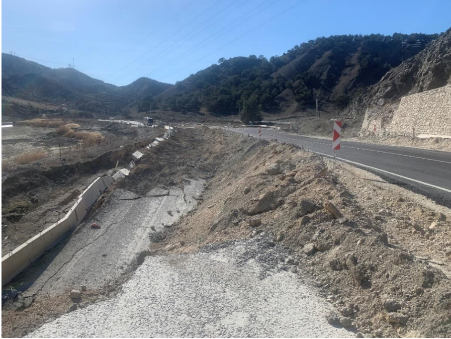
Şekil 6.4. Karayolu güzergahında meydana gelen yanal yayılma kaynaklı heyelan
