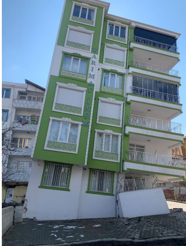
Şekil 4.11. Gölbaşı ilçesinde bir yapıda gözlenen farklı oturma ve deformasyonlar
