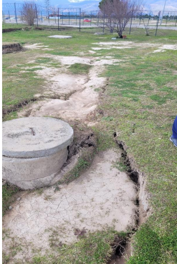
Şekil 4.5. Hatay Hava Limanı yerleşkesinde oluşan düşey deformasyonlar ve kum fişkirmaları
