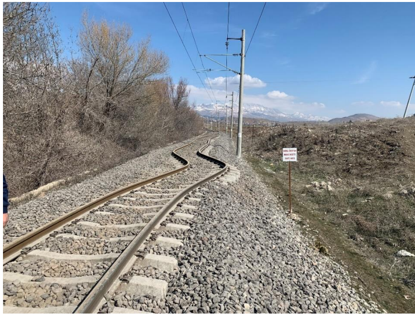
Şekil 4.19. Raylarda meydana gelen sol yanlı atım
