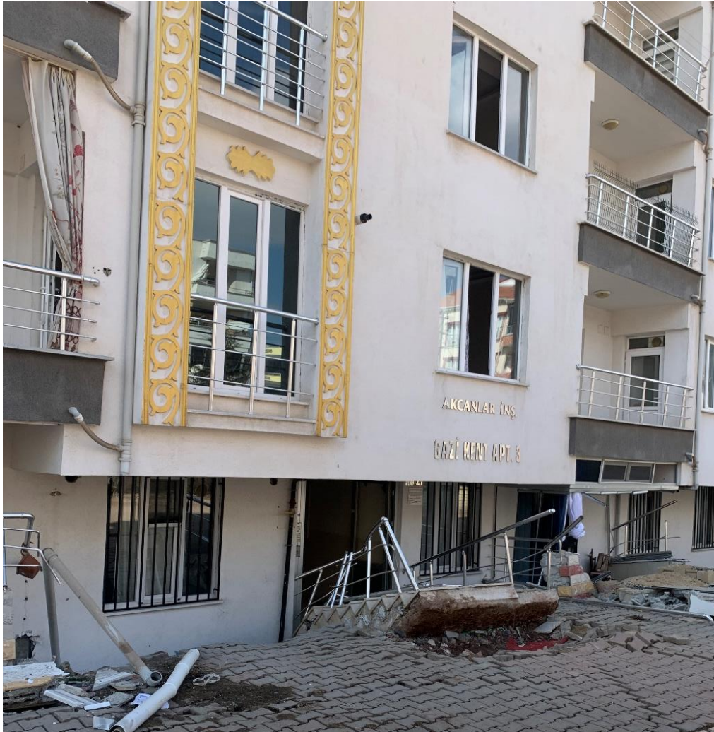
Şekil 4.7. Gölbaşı ilçesinde radye temel üzerindeki yapıda gözlenen düşey deformasyon
