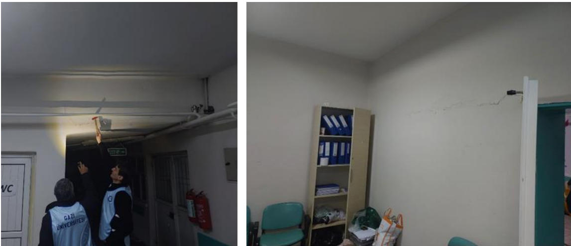
Şekil 5.19. Yığma yapı hasarları (1)
