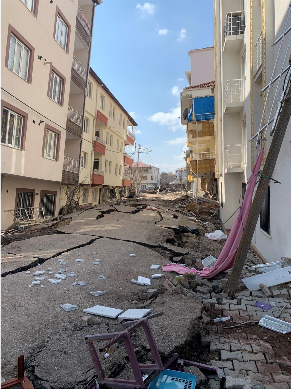
Şekil 4.6. Gölbaşı ilçesinde gözlenen ve sıvılaşma kaynaklı olduğu düşünülen zemin deformasyonları sebebi ile oluşan hasarlar
