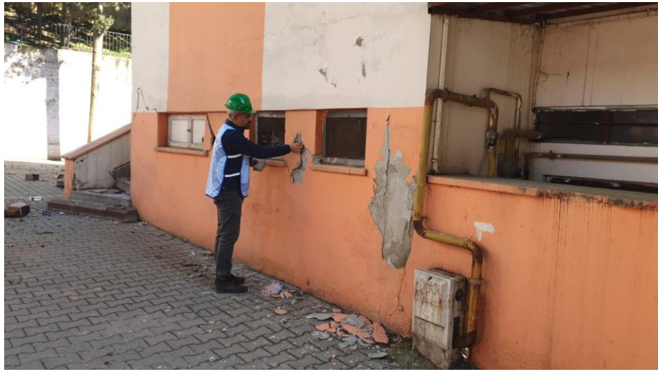
Şekil 5.6. Kısa kolona hasarı (1)
