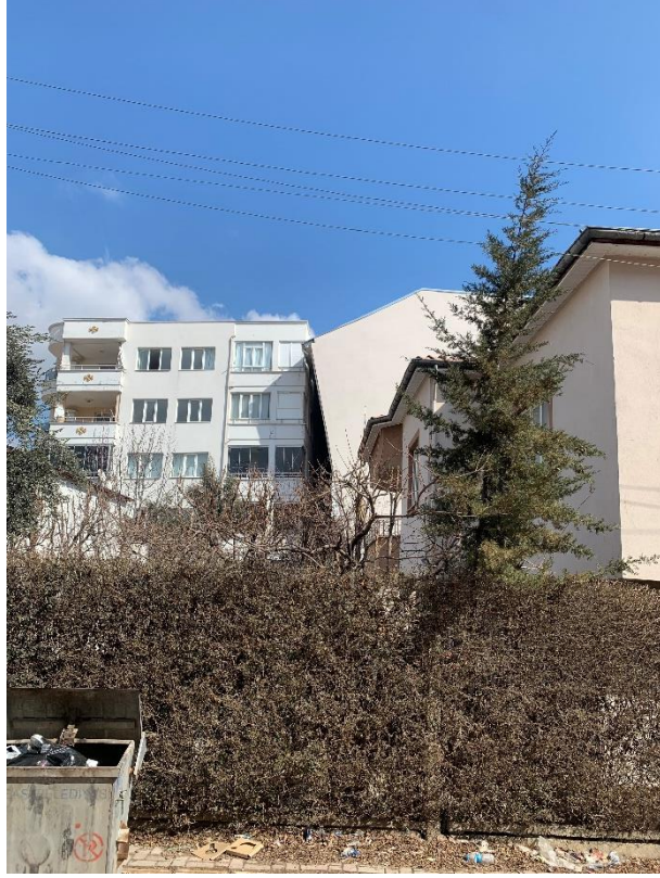
Şekil 4.8. Gölbaşı ilçesinde radye temel üzerindeki yapıda gözlenen farklı oturma ve dönme
