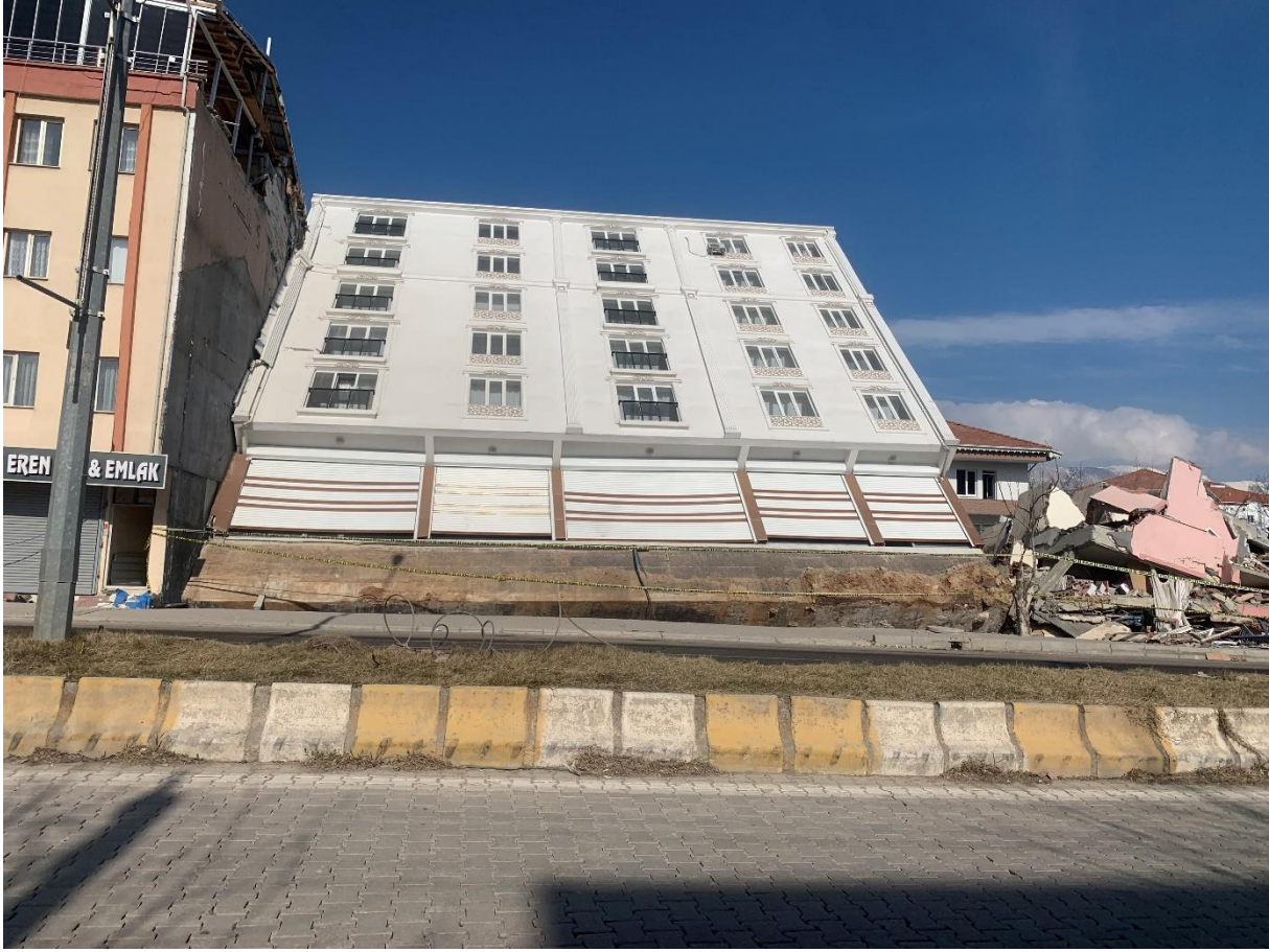
Şekil 4.12. Gölbaşı ilçesinde bir yapıda gözlenen taşıma gücü yenilmesi
