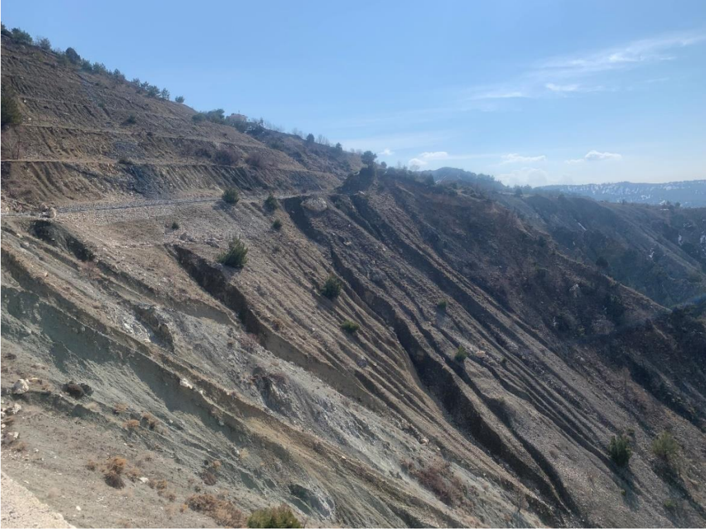
Şekil 4.14. Karayolu güzergahındaki bir yamaçta oluşan heyelan/akma
