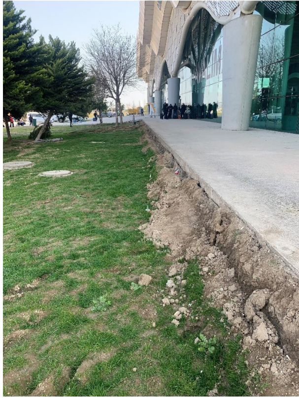
Şekil 4.3. Hatay Hava Limanı yerleşkesinde meydana gelen düşey deformasyonlar (sebebinin belirlenmesi için ek çalışmaya ihtiyaç bulunmaktadır)
