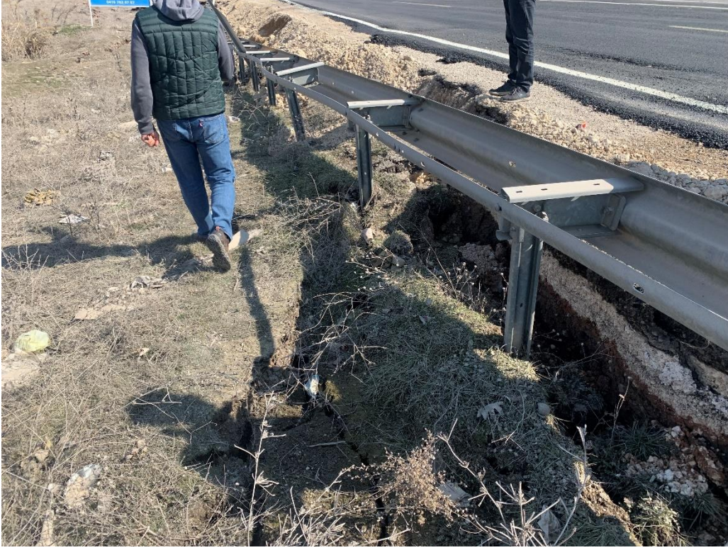
Şekil 4.18. Karayolu dolgusunda meydana gelen hasar
