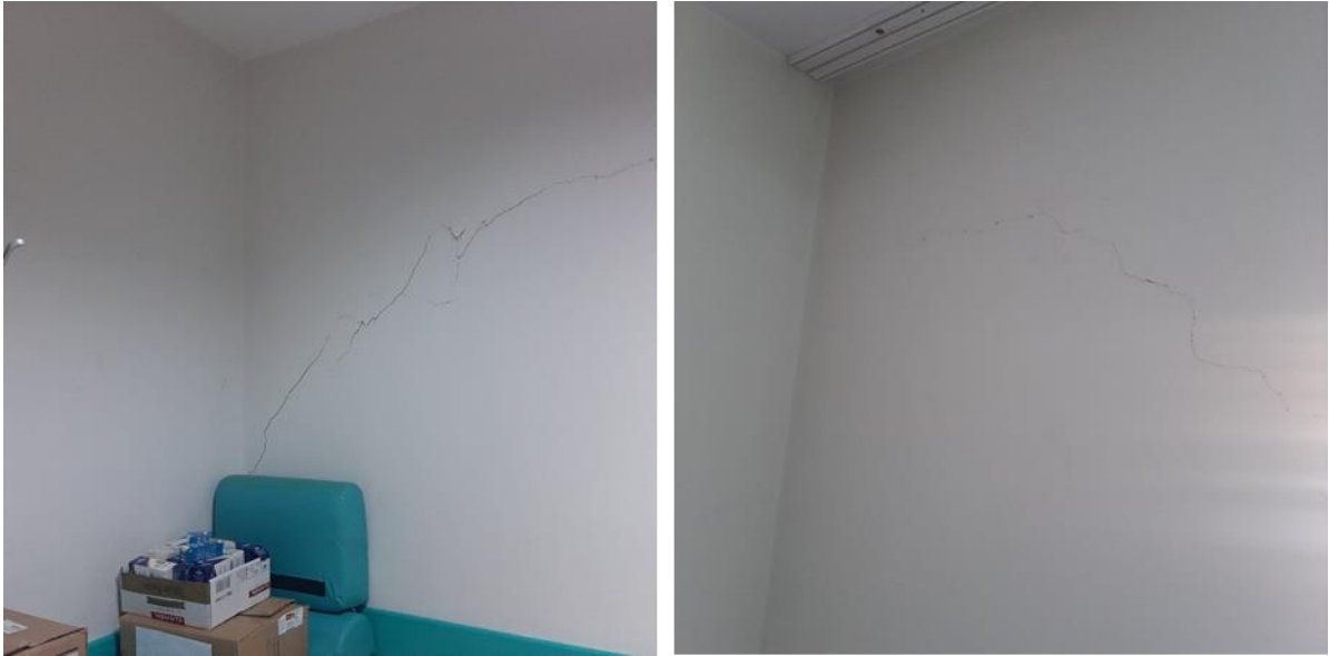
Şekil 5.21. Yığma yapı hasarları (3)
