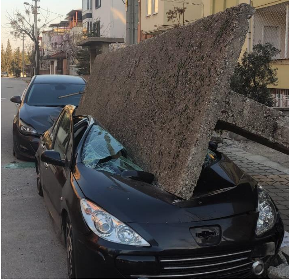
Şekil 5.15. Yapısal olmayan eklentilerin deprem hasarı (1)
