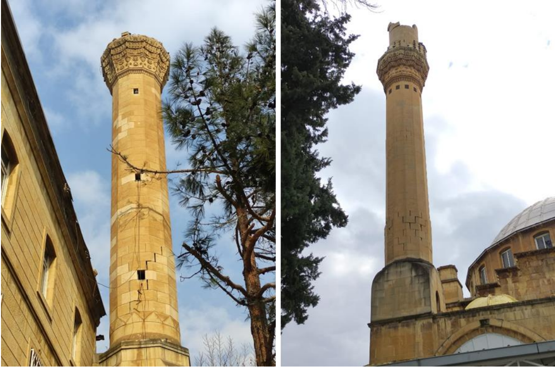
Şekil 5.27. Cami minaresi hasarları (2)
