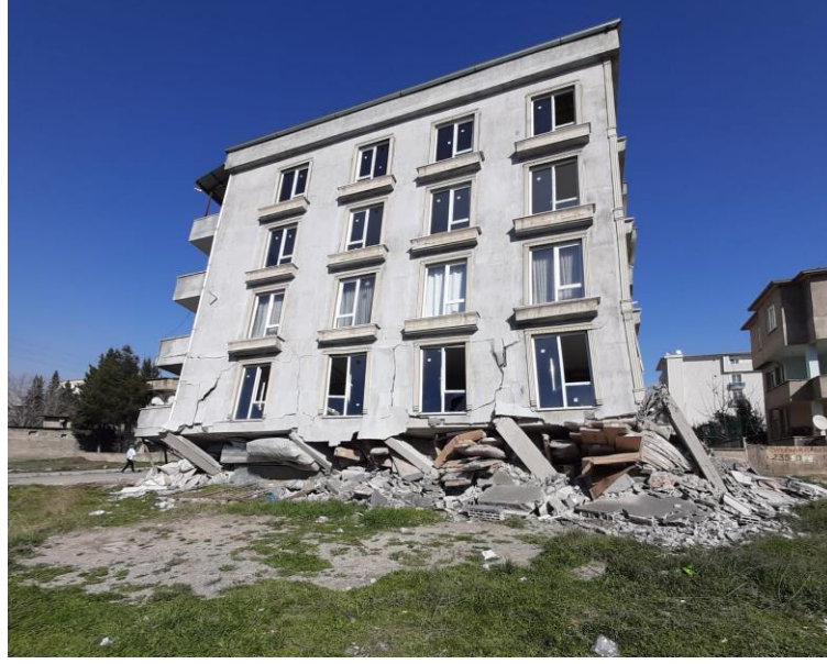
Şekil 5.2. Yumuşak kat oluşumu nedeniyle göçen konut türü yapı (1)
