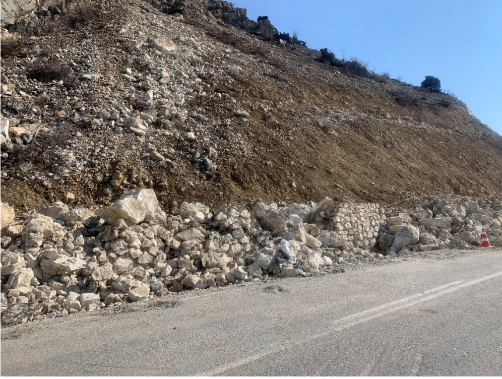
Şekil 6.3. Karayolu güzergahında meydana gelen kaya düşmesi
