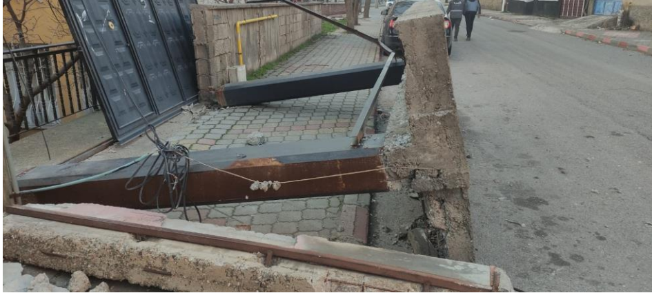
Şekil 5.16. Yapısal olmayan eklentilerin deprem hasarı (2)
