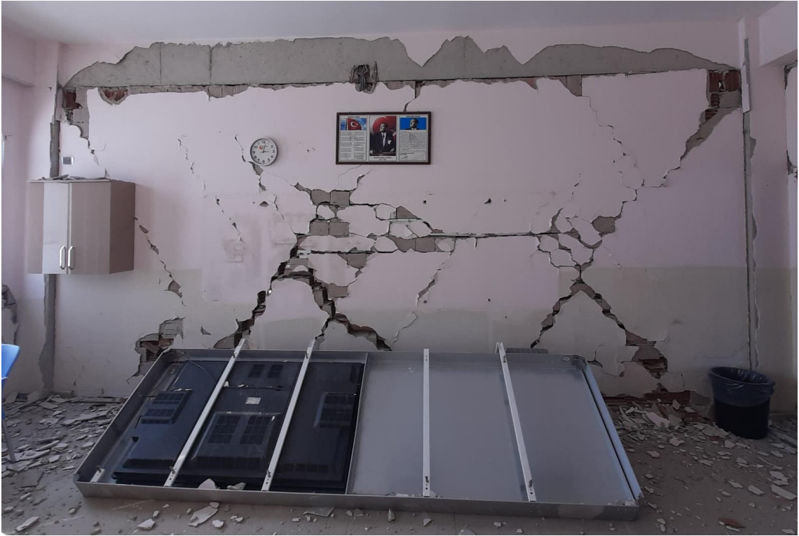
Şekil 5.24. Düzlem içi dolgu duvar hasarı (1)
