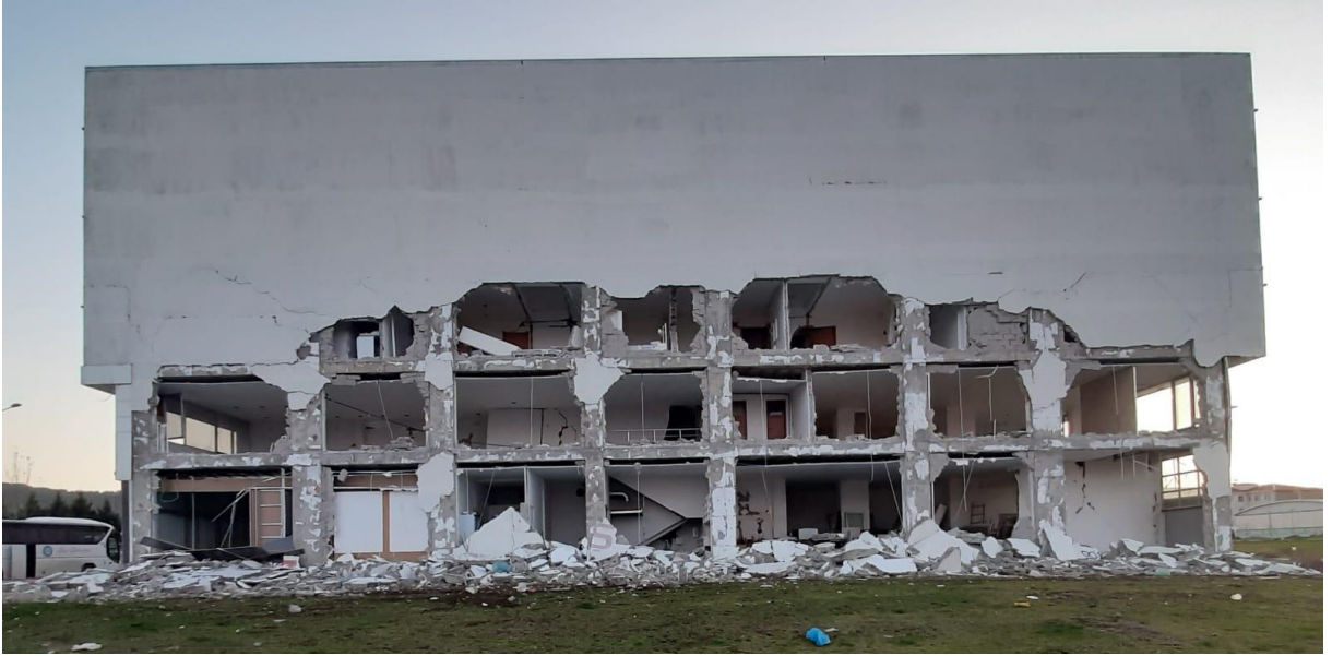
Şekil 5.22. Düzlem dışı dolgu duvar hasarı (1)
