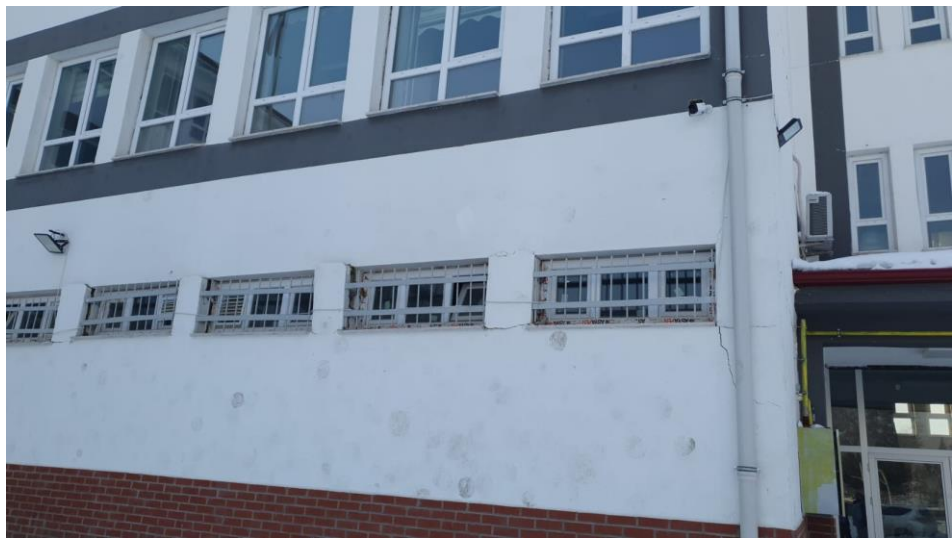
Şekil 5.7. Kısa kolona hasarı (2)
