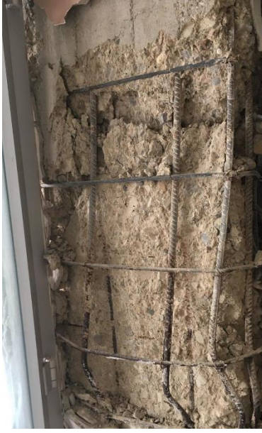
a) Düz yüzeyli etriye ve beton kalitesi
