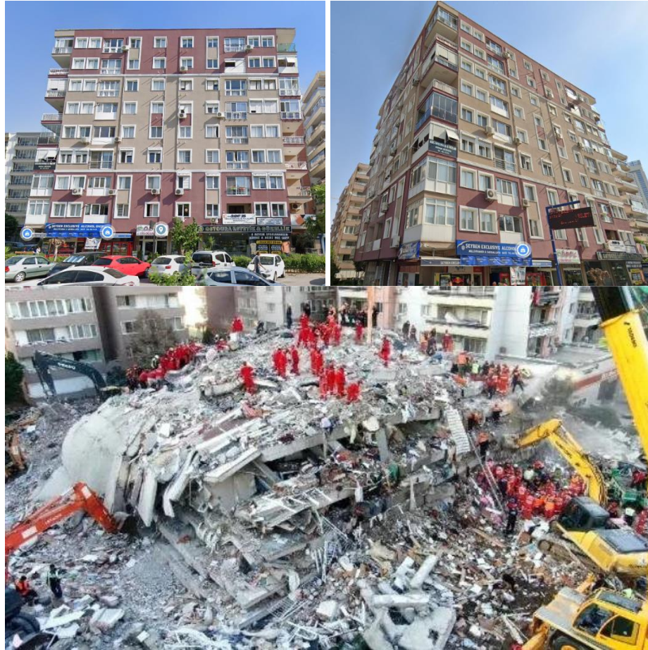
Şekil 4.2. Tamamen yıkılan Rıza Bey Apartmanı
