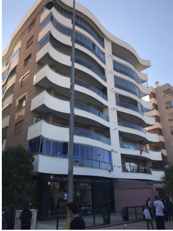
Şekil 4.8 : Rızabey Apt. civarında göçmeyen ve dış cephede hasar gözlemlenmeyen binalar
