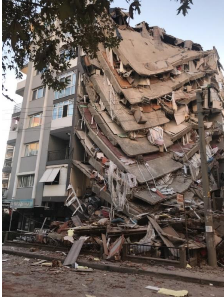
Şekil 4.24 : Z+7 Katlı Bina: Karagöl Apt. deprem sonrası fotoğrafı
