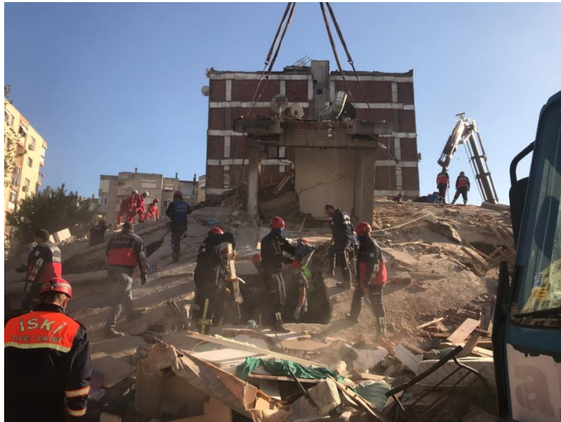
Şekil 4.11 : Zemin+7 katlı Doğanlar Apt., Toptan göçen A Blok ve stabilitesini koruyan B Blok (arkada) deprem sonrası fotoğrafı
