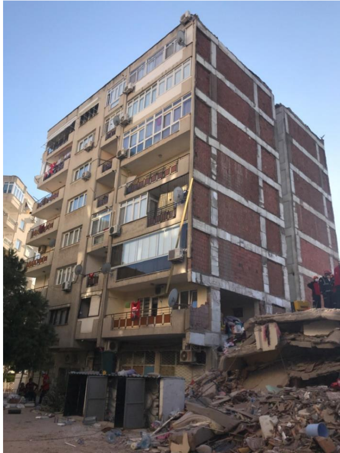
Şekil 4.13 : Zemin+7 katlı Doğanlar Apt., Toptan göçen A Blok ve stabilitesini koruyan B Blok
