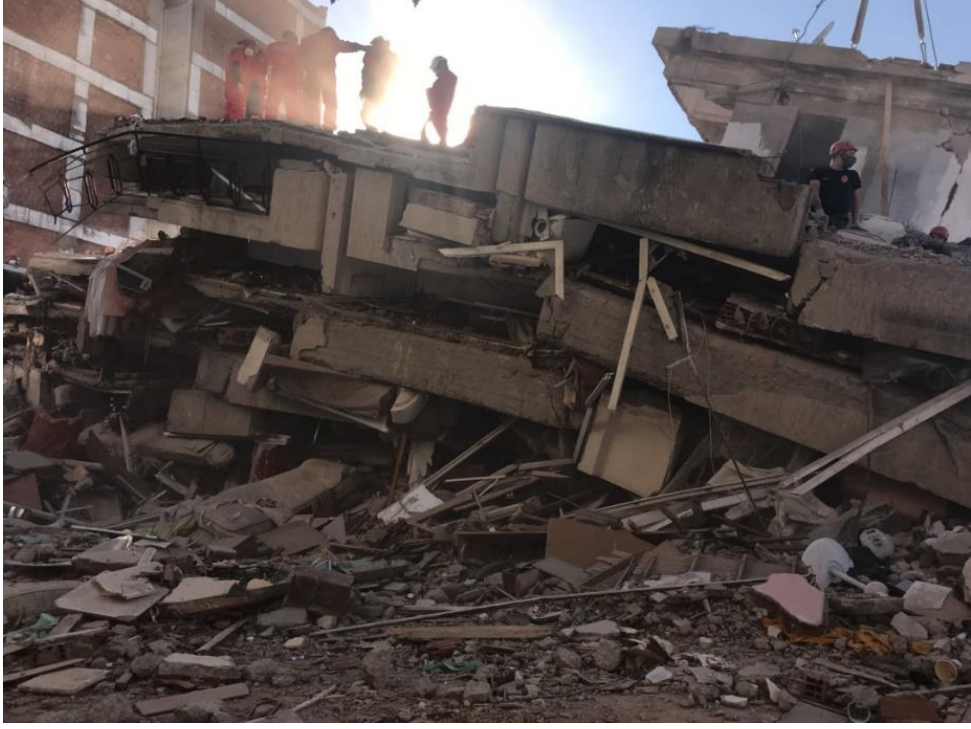
Şekil 4.12 : Zemin+7 katlı Doğanlar Apt., Toptan göçen A Blok ve stabilitesini koruyan B Blok(solda)
