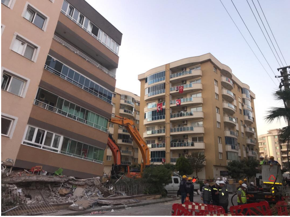
Şekil 4.36 : Z+7 Katlı Binalardan oluşan Barış Sitesi, zemin kat kolonlarında göçme
