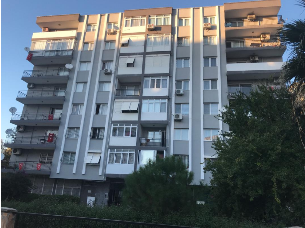
Şekil 4.25 : Z+7 Katlı Karagöl Apt. depremden sonra stabilitesini koruyan kısım
