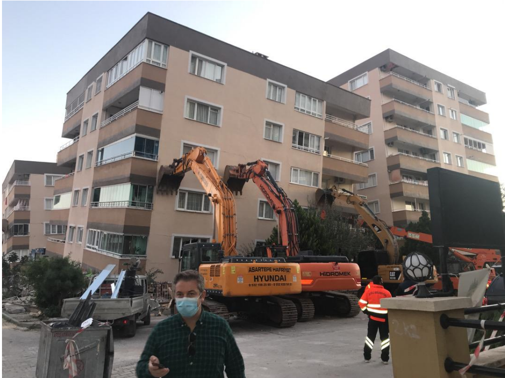
Şekil 4.37 : Z+7 Katlı Binalardan oluşan Barış Sitesi, zemin kat kolonlarında göçme yaşanan ve yapı stabilitesini koruyan blok (sağda)
