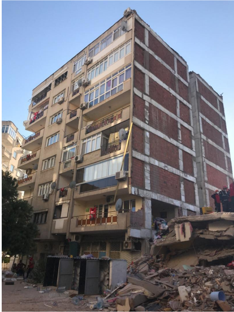
Şekil 5.1 : Z+7 Katlı Doğanlar Apt., Zemin kat yüksekliğinin üst katlardan farklı olması ve zemine katta ticarethane olması sebebiyle tuğla duvarların yerinde cam olması
