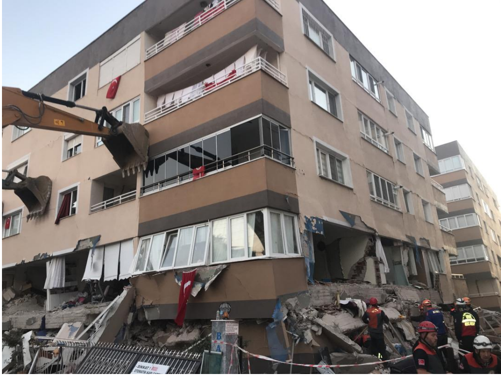
Şekil 4.34 : Z+7 Katlı Binalardan oluşan Barış Sitesi, zemi kat kolonlarında göçme
