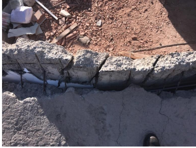
Şekil 5.10 : Z+7 Emrah Apt. Korozyona uğramış donatılar
