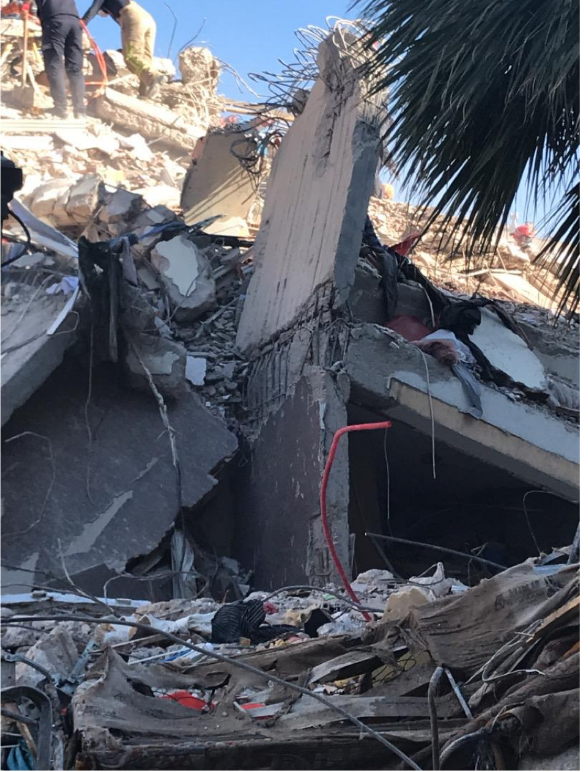
Şekil 5.5 : Z+7 Katlı Emrah Apt. kolon-kiriş birleşim yerinde etriye bulunmaması
