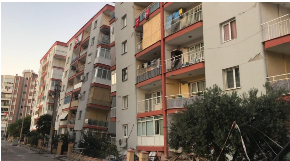
Şekil 4.39 : Z+7 Katlı Binalardan oluşan Cumhuriyet Sitesi, sağdaki iki blok zemin kat kolonlarında göçmeye bağlı binalarda dönme meydana gelmiştir. Sol uçtaki binanın yapı stabilitesini koruduğu gözlenmiştir.
