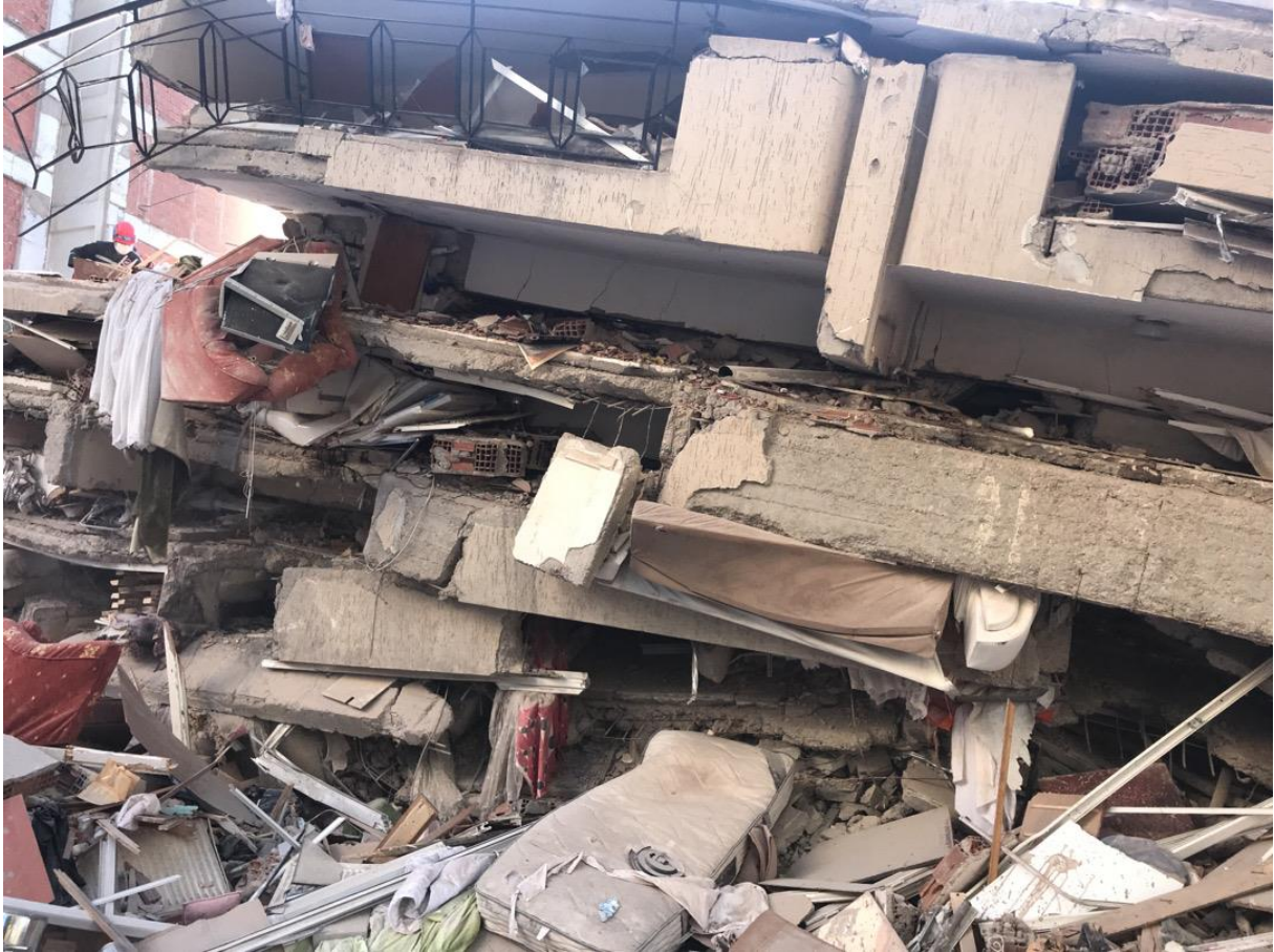
Şekil 5.4 : Z+7 Katlı Doğanlar Apt., güçlü kolon zayıf kiriş ilkesinin hesapla gerçekleştirilmemiş olması
