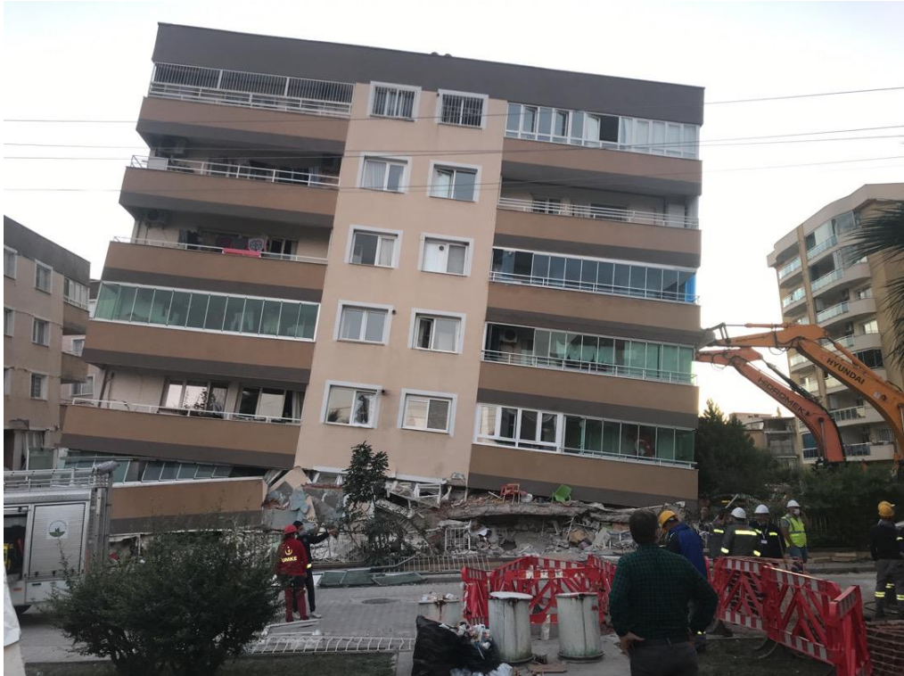
Şekil 4.35 : Z+7 Katlı Binalardan oluşan Barış Sitesi, zemin kat kolonlarında göçme
