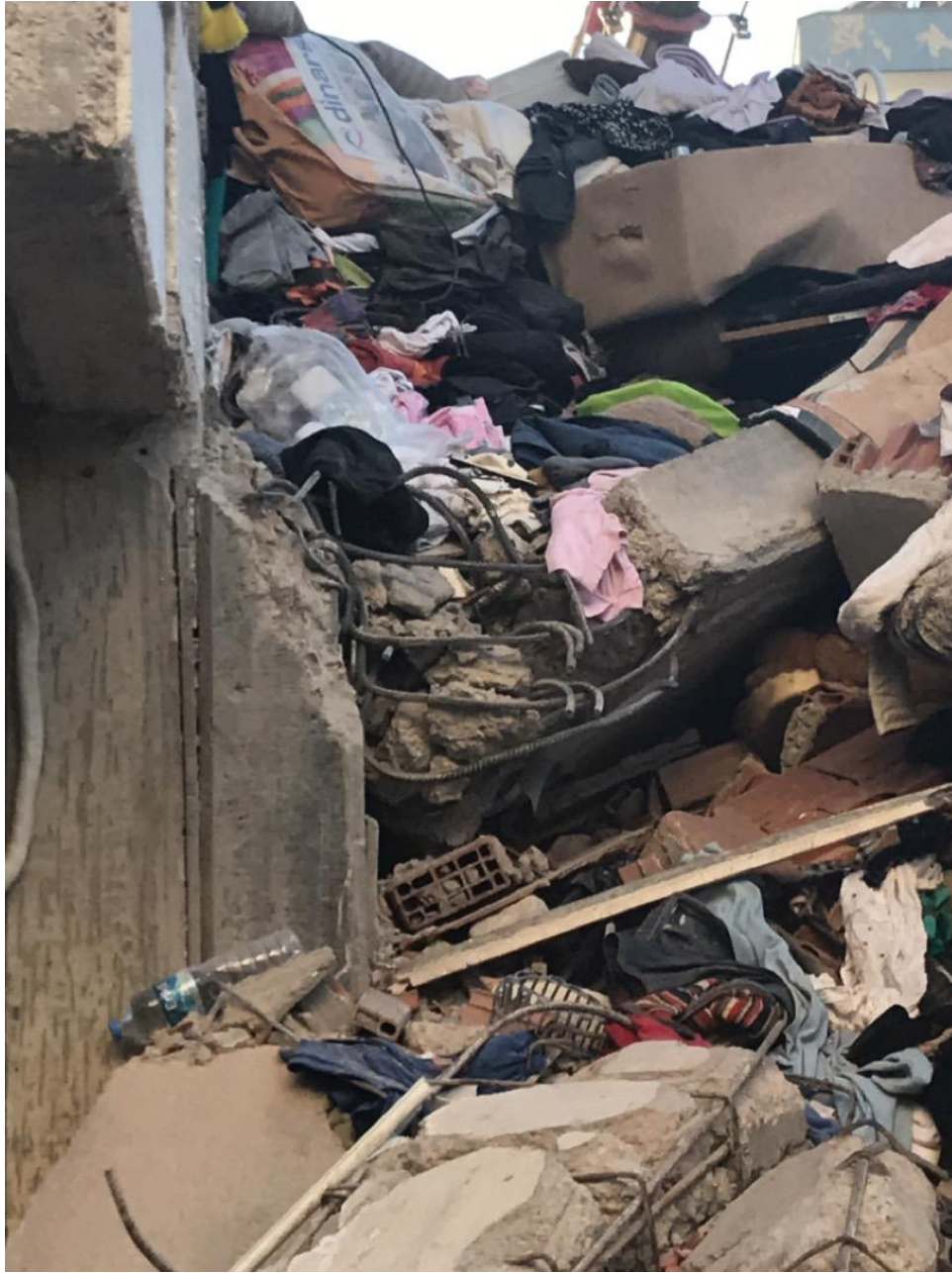
řekil 5.2 : Z+7 Katlı Dođanlar Apt., Zemin Kat kolonu eksenel-kesme gçmesi,
