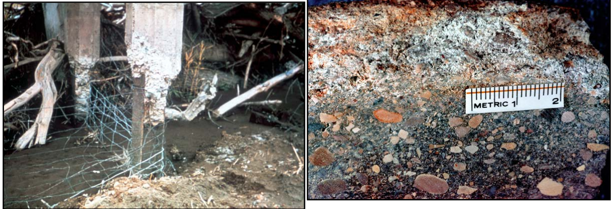
Resim 28-29: Sülfat etkisi sonucu beton görünümü
