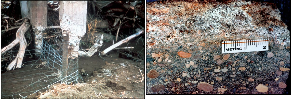
Resim 28-29: Sülfat etkisi sonucu beton görünümü
