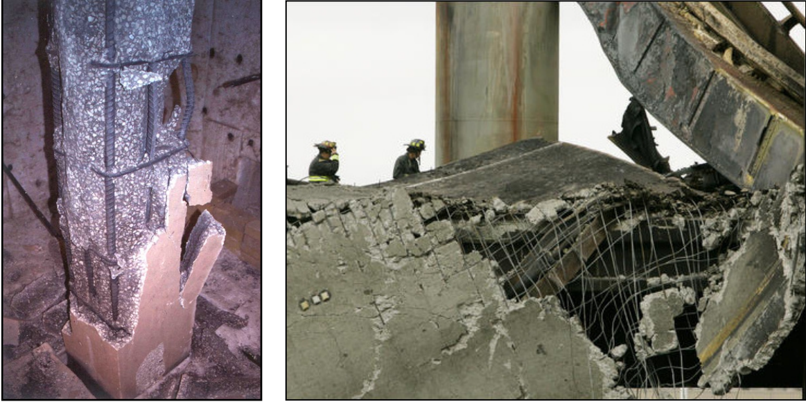
Resim 34-35: Yangın dayanım testi sonucu betonun görünümü
