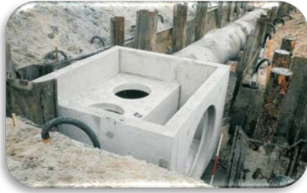
Resim 8: YFC çimento ile yapılmış kanalizasyon altyapısı
