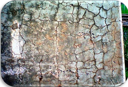
Resim 9: Alkali-silika reaksiyonu sonucu oluşan hasar
