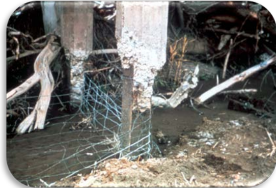
Resim 10: Betonarme yapıda sülfat etkisi
